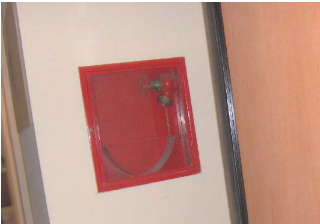
Foto N° 2 – Cabina para la manguera del sistema contra incendio en el 8° piso, es de notar que esta vacía sin la manguera y la lanza (en el 7° piso se puede ver que la cañería de alimentación sale de la cabina y penetra en la pared).
