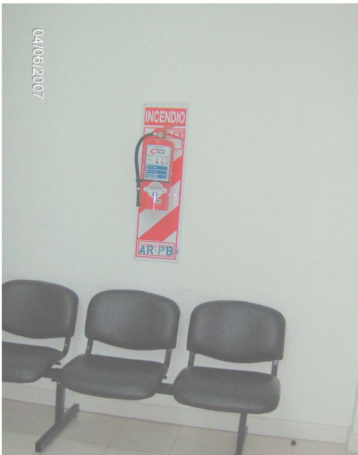
Foto N° 6 – Sala de espera con un matafuegos bajo la chapa reglamentaria con la carga vigente y asientos corridos.
