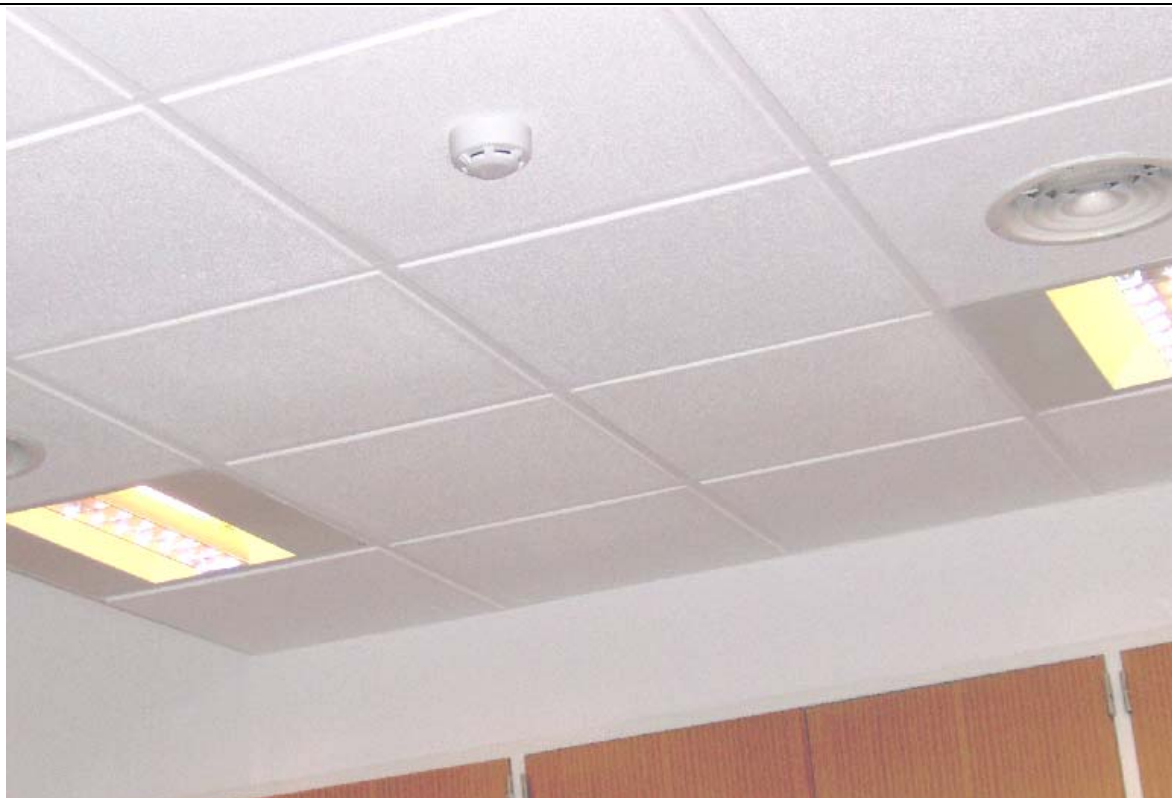
FOTO N° 17 – VISTA DEL CIELORRASO DE UNA OFICINA CON LOS ARTEFACTOS DE ILUMINACIÓN EMBUTIDOS, CENSORES DE HUMO Y SALIDAS DEL AA.
