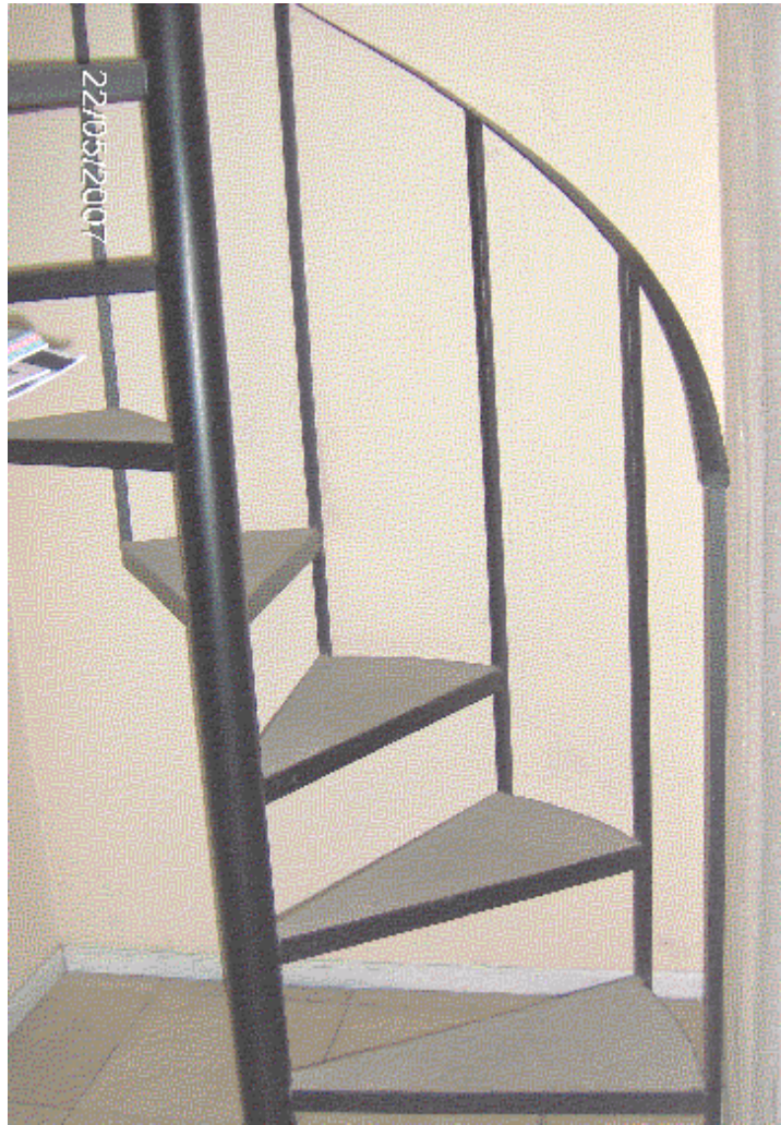
Foto N° 7 - Escalera tipo caracol de herrería en el arranque del piso 9° sube desde este nivel a la terraza, esta escalera de 0,55 m de ancho es prefabricada y no cumple con las medidas mínimas (según el CE 4.6.3.5 a) (2) El ancho libre no será menor que 0,70 m.) .
