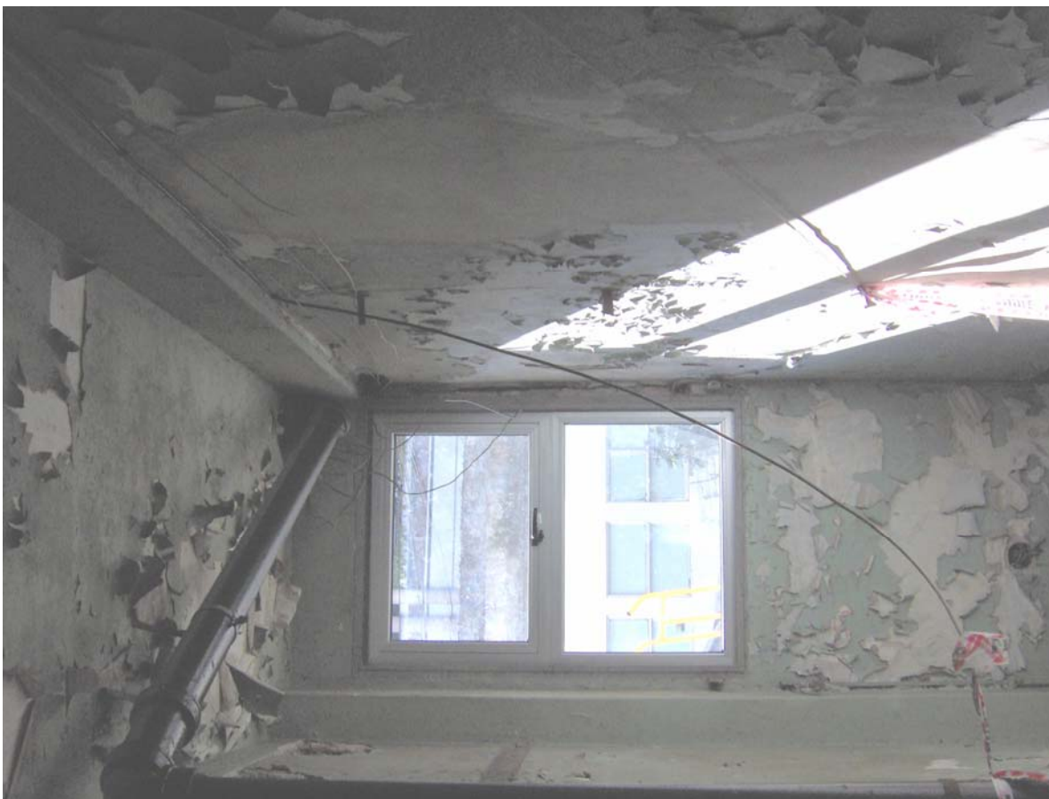
Foto N° 37 – Otro sector del primer piso sin refaccionar.
