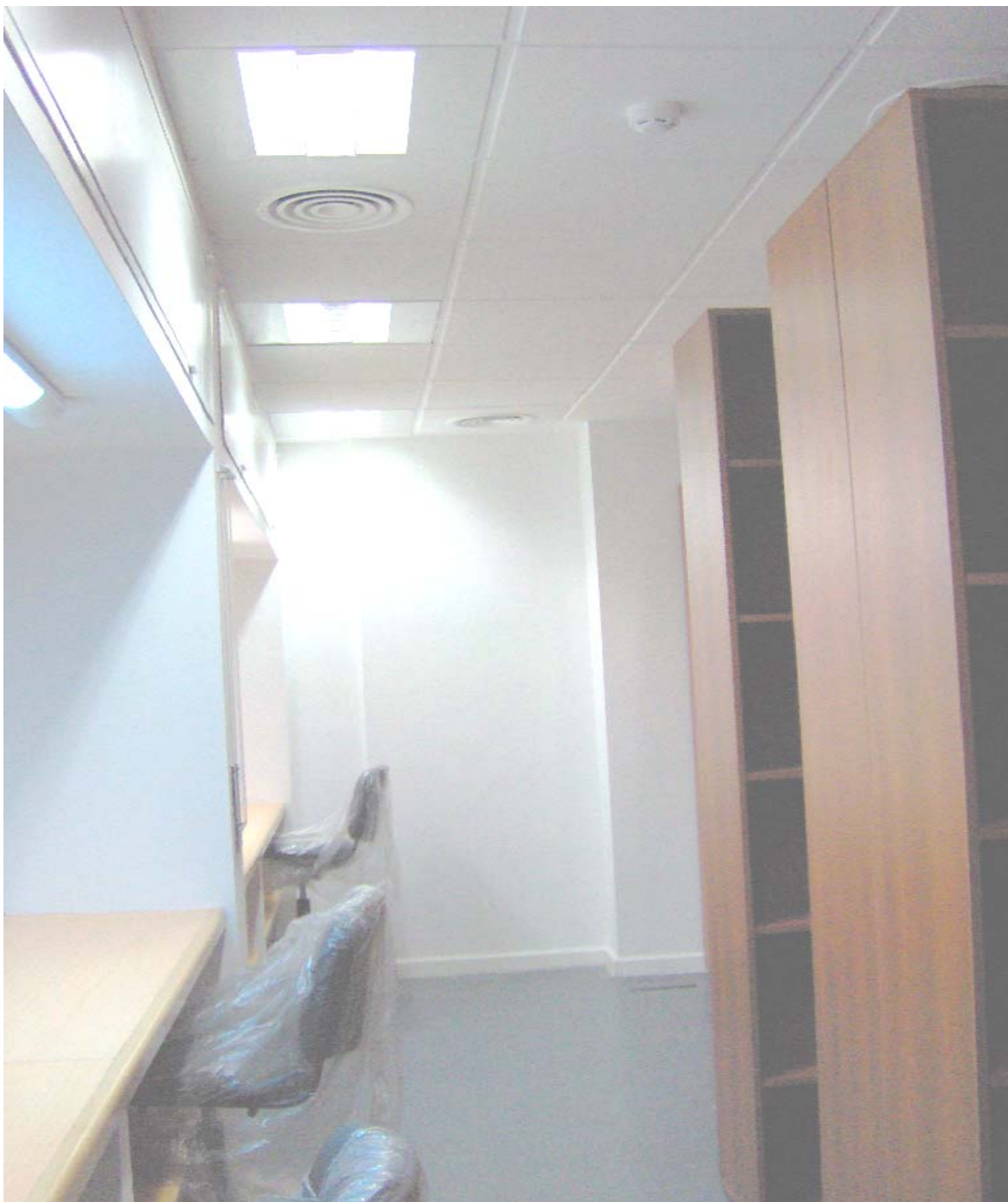
FOTO N° 3 – INTERIOR DE UN PISO DE OFICINAS CON PUESTOS DE TRABAJO, SOBRE EL CIELORRASO ARMADO FORMADO POR PANELES ACÚSTICOS DE 50 x 50 CM DE LADO, ENCONTRAMOS EMBUTIDOS LOS ARTEFACTOS DE ILUMINACIÓN, LOS DETECTORES DE HUMO Y LAS SALIDAS DEL AIRE ACONDICIONADO CENTRAL. A LA DERECHA PODEMOS OBSERVAR LOS MUEBLES-ARCHIVOS QUE VAN DESDE EL PISO HASTA EL CIELORRASO.
