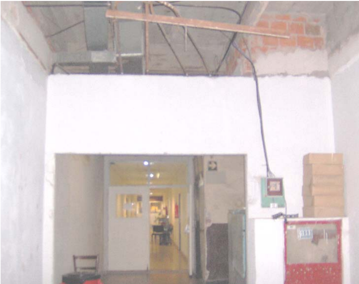
FOTO N° 34 – EN LA PRESENTE VISTA SE PUEDE APRECIAR EN EL PASILLO AL FONDO TODO UN SECTOR YA RECICLADO, CON MATAFUEGOS, EL CIELORRASO ARMADO TERMINADO, CON LA ILUMINACIÓN DENTRO DE LOS ARTEFACTOS (AUNQUE SIN PLANO DE EVACUACIÓN) Y POR OTRO LADO EN LA PARTE DE ADELANTE TODAVÍA EN OBRA CON CABLES EXPUESTOS, LA CABINA PORTA MANGUERAS VACÍA Y SIN EL CIELORRASO ARMADO. LO NOTABLE ES QUE EN EL OTRO SECTOR LA GENTE ESTA TRABAJANDO Y EN ESTE SECTOR EN LA PARTE DE ARCHIVO TAMBIÉN SE TRABAJA PERO SIN LAS MEDIDAS CORRECTAS DE SEGURIDAD.
