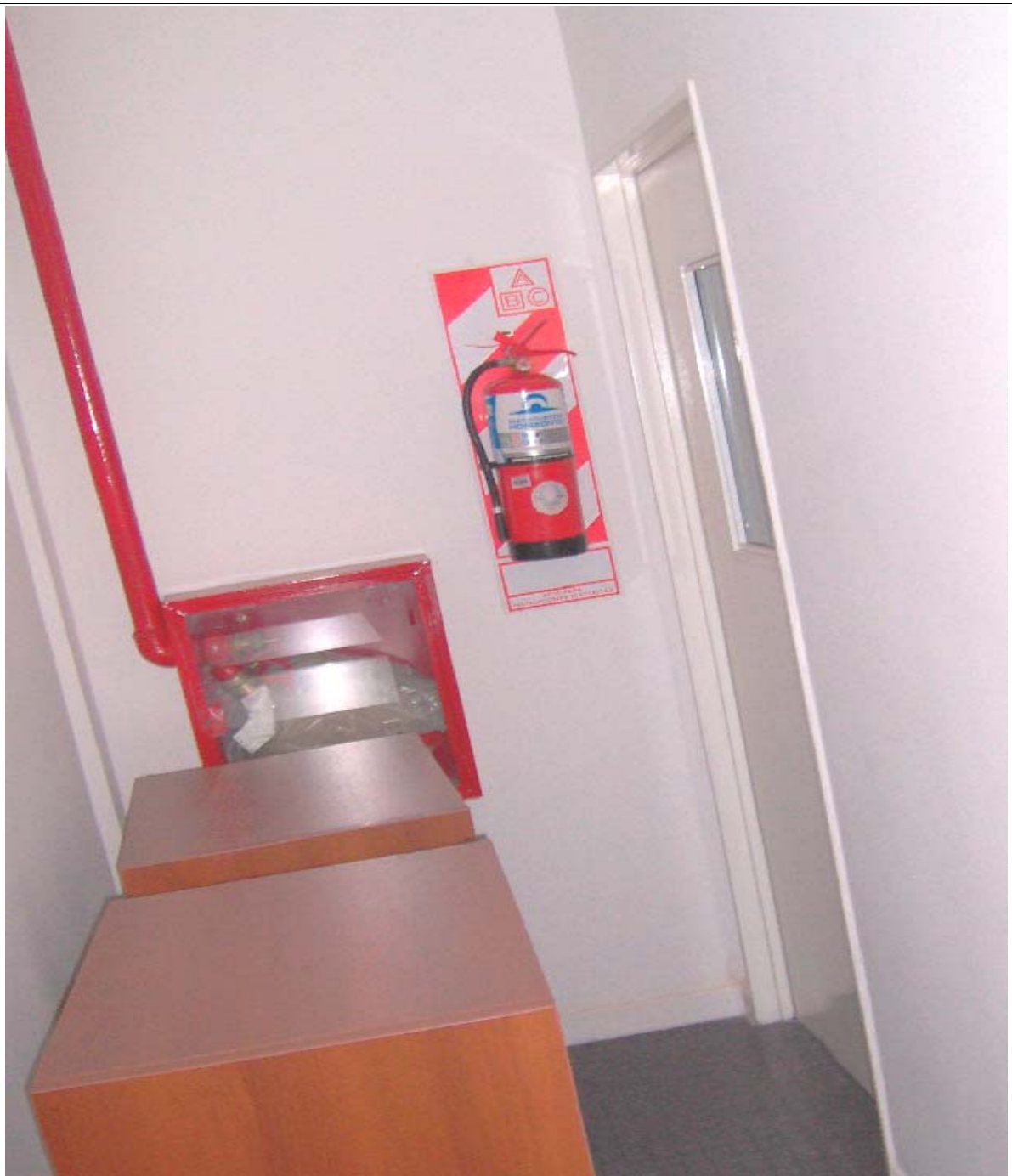
FOTO N° 5 – EN LA PRESENTE VISTA SE PUEDE APRECIAR UN NICHOS PARA MANGUERA CONTRA INCENDIO Y COLGADO EN LA PARED UN MATAFUEGOS SOBRE UNA CHAPA CON LAS LETRAS IDENTIFICATORIA DEL TIPO DE FUEGO QUE PUEDE ATACAR A; FUEGO EN GENERAL, B; POR COMBUSTIBLES, C; A INSTALACIONES ELÉCTRICAS (EL ORGANISMO HA CONTRATADO UNA EMPRESA QUE SE ENCARGA DEL MANTENIMIENTO Y CARGA DE LOS MATAFUEGOS Y CUMPLE CON EL CE 4.12 QUE DICE UN ARTEFACTO CADA DOSCIENTOS M2 DE SUPERFICIE DE PISO).
