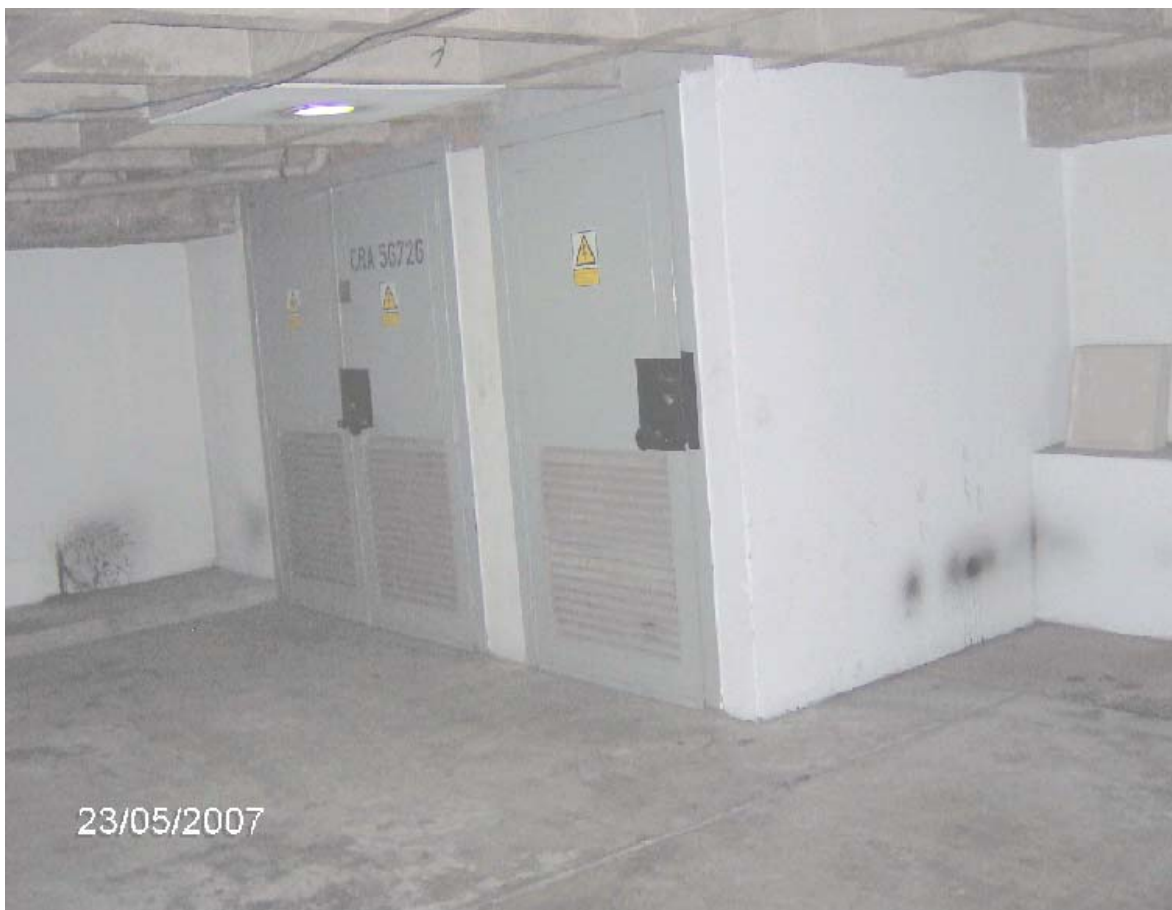
Foto N° 22 – En planta baja se pueden ver los recintos para los transformadores de Edesur observados en la foto anterior y en el techo colgando del mismo “cables de electricidad expuestos” .
