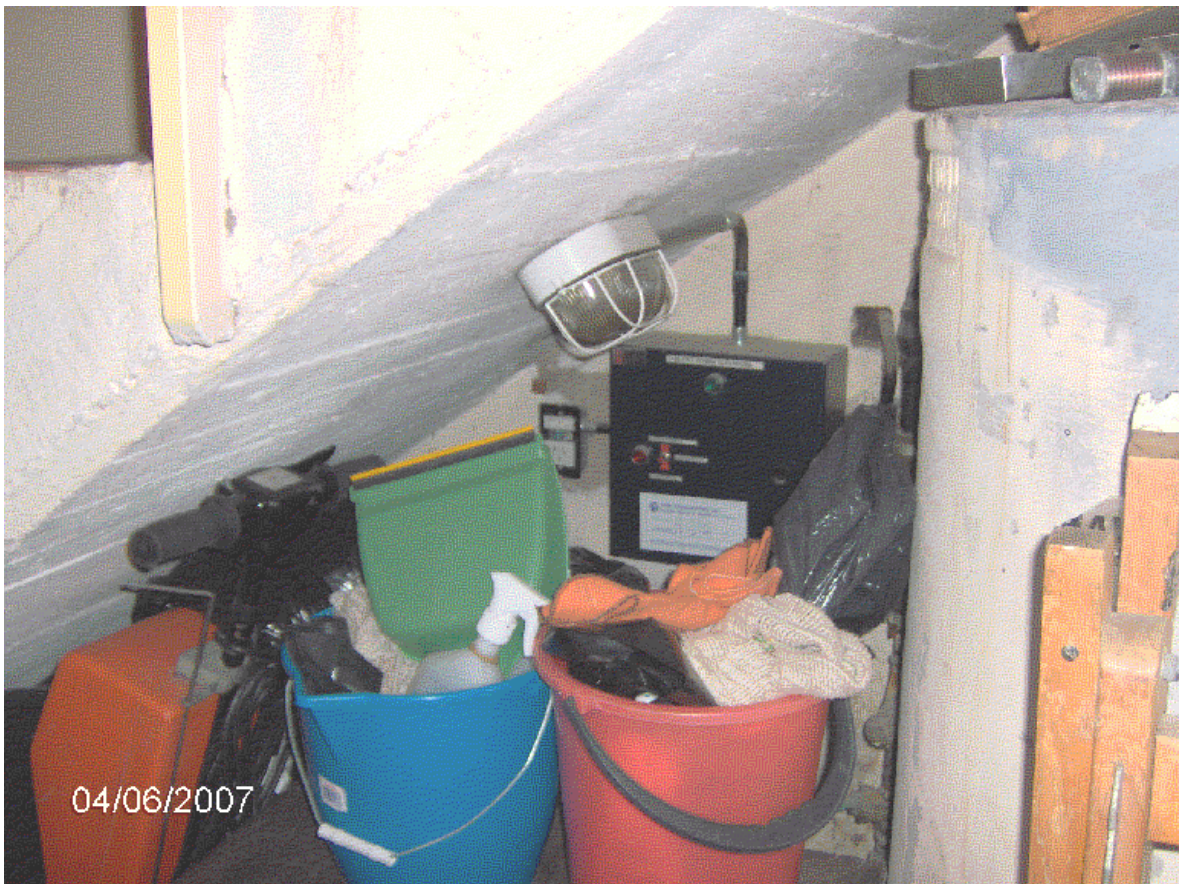
Foto N° 9 – En este bajo-escalera se pueden observar baldes, botellas, trapos, etc. Detrás de estos elementos están las motobombas que toman el agua del tanque de bombeo (a la derecha) y lo elevan al tanque de reserva en la terraza y el tablero de electricidad de estas bombas un poco mas arriba con una luz de emergencia bajo la escalera que actúa cuando hay corte de electricidad (esto no cumple en lo que hace a la seguridad, el tablero de electricidad y las bombas de agua no deben tener ningún tipo de elemento que los tapen y no permitan actuar inmediatamente sobre ellos). En este subsuelo hay tres depósitos dos para la fiscalia y uno para la defensoría.
