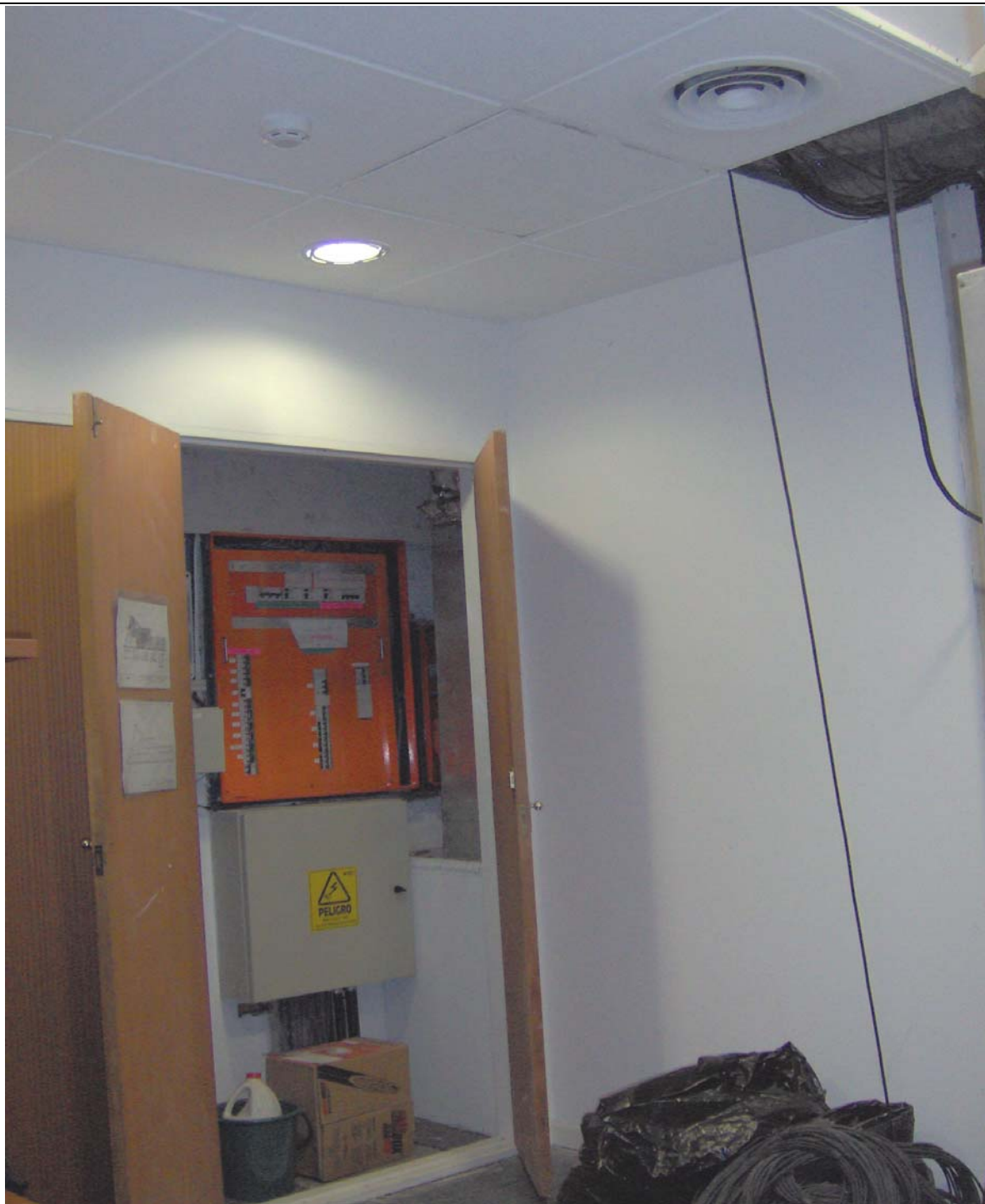
FOTO N° 4 – EN LA PRESENTE VISTA SE PUEDE OBSERVAR EL TABLERO CENTRAL DEL SISTEMA CONTRA INCENDIO, DESDE AQUÍ SE CONTROLA TODO EL EDIFICIO. EN EL CIELORRASO VEMOS UN ARTEFACTO DE ILUMINACIÓN EMBUTIDO, UN DETECTOR DE HUMOS Y UNA SALIDA DEL AIRE ACONDICIONADO (EL PANEL QUE FALTA SE DEBE A LOS TRABAJOS QUE TODAVÍA SE ESTÁN REALIZANDO).
