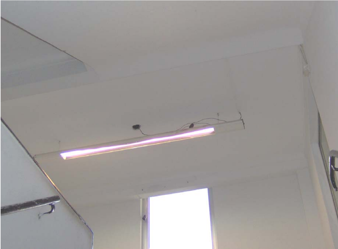
Foto N°36 – Iluminación sobre un descanso de la escalera del primer piso alimentada con cables eléctricos expuestos y encintados.
