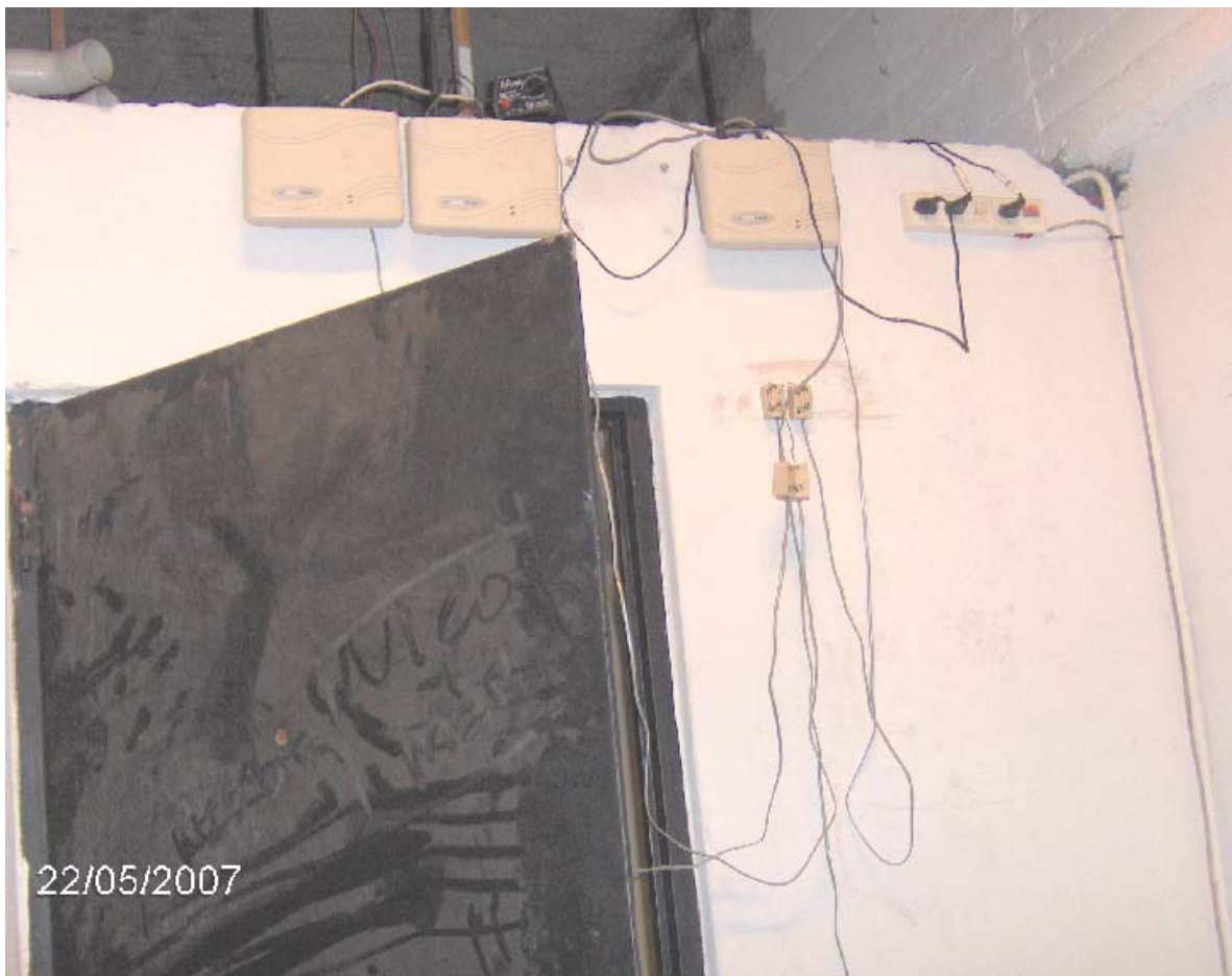
Foto N° 13 – Sala de motores de los ascensores, en la presente vista se pueden observar sobre la puerta de entrada cables de telefonía, sensores para captación de celulares y conductores de electricidad expuestos y encintados conectados a un toma múltiple.
