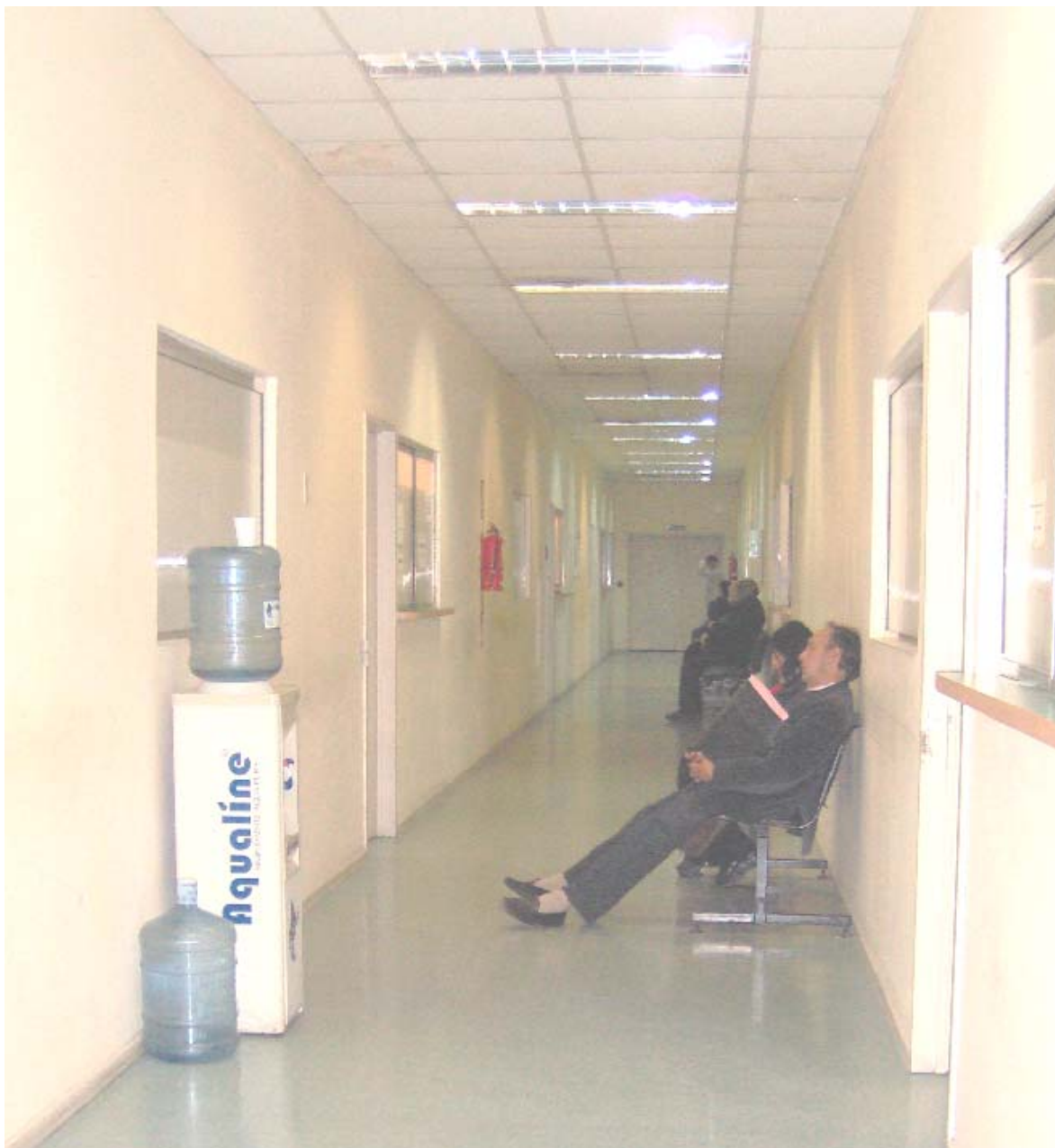
FOTO N° 3 – PASILLO DEL PRIMER PISO USADO COMO CORREDOR Y “SALA DE ESPERA”, EL CIELORRASO ES ARMADO Y POR ENCIMA DEL MISMO PASAN CONDUCTORES ELÉCTRICOS Y DE SISTEMAS, AL COSTADO UN DISPENSER DE AGUA Y VARIOS ASIENTOS JUNTO A UNA PARED.
