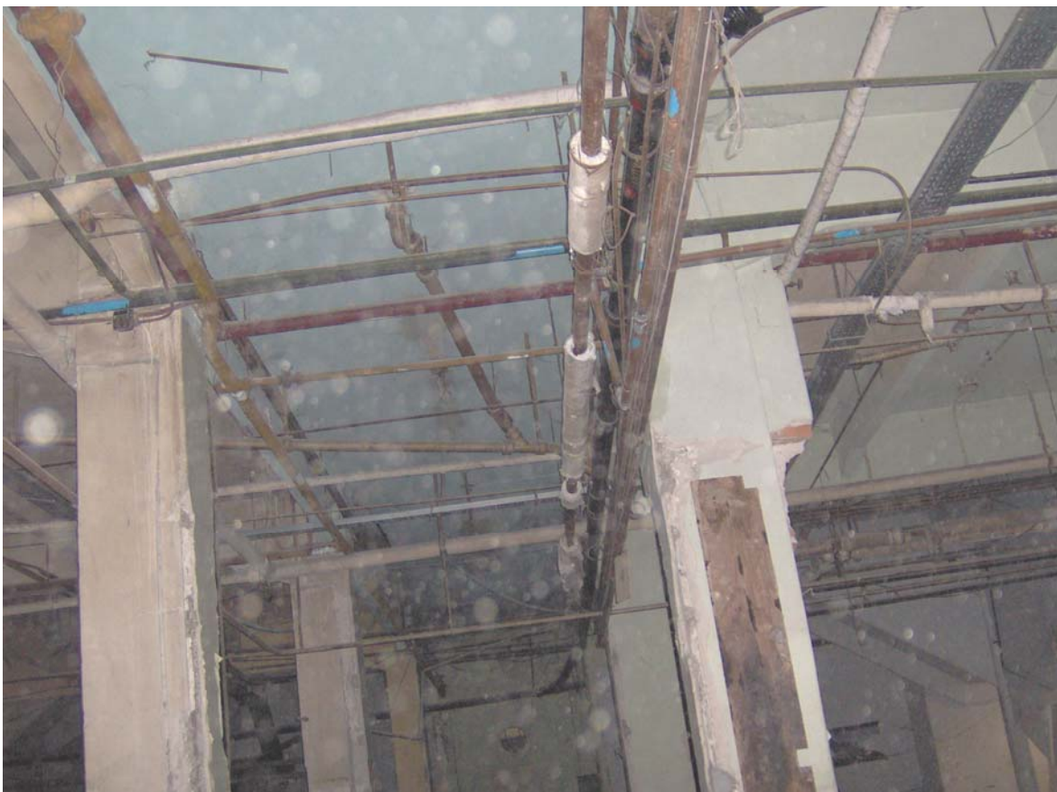
Foto N° 39 – Sector del subsuelo con el cielorraso, las paredes y columnas desmanteladas (este lugar sirve como depósito de muebles y enseres).
