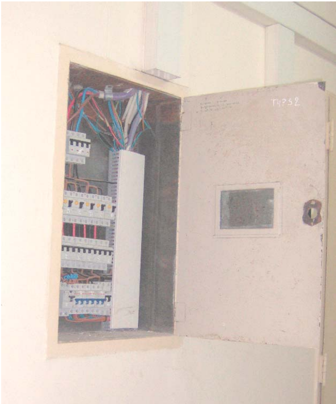
Foto N° 17 - Tablero seccional del cuarto piso sin contratapa y los cables expuestos y encintados.
