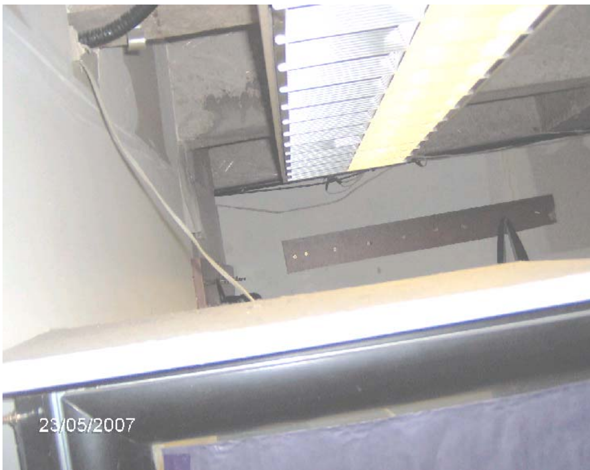
Foto N° 25 – En el mismo recinto donde se encuentra la pileta de natación se pueden observar cables de electricidad expuestos y encintados junto a cables de sistemas.
