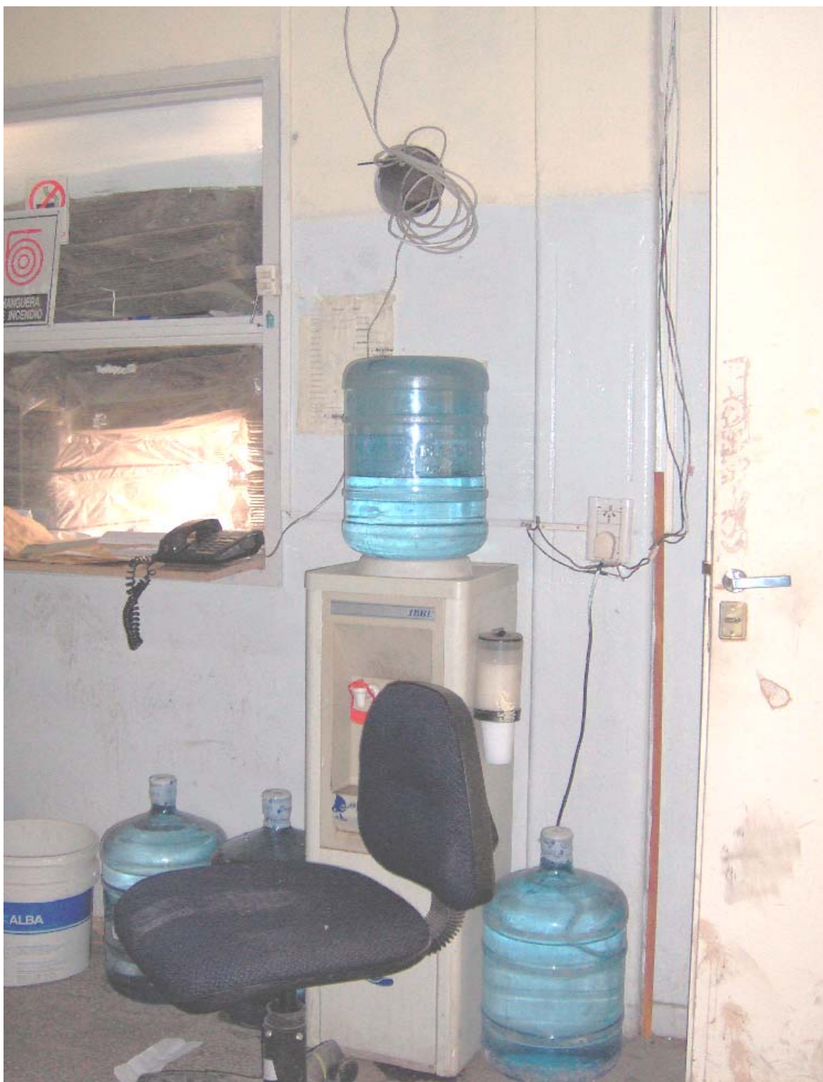
Foto N° 12 – Office del cuarto piso con cables de electricidad expuestos y encintados
