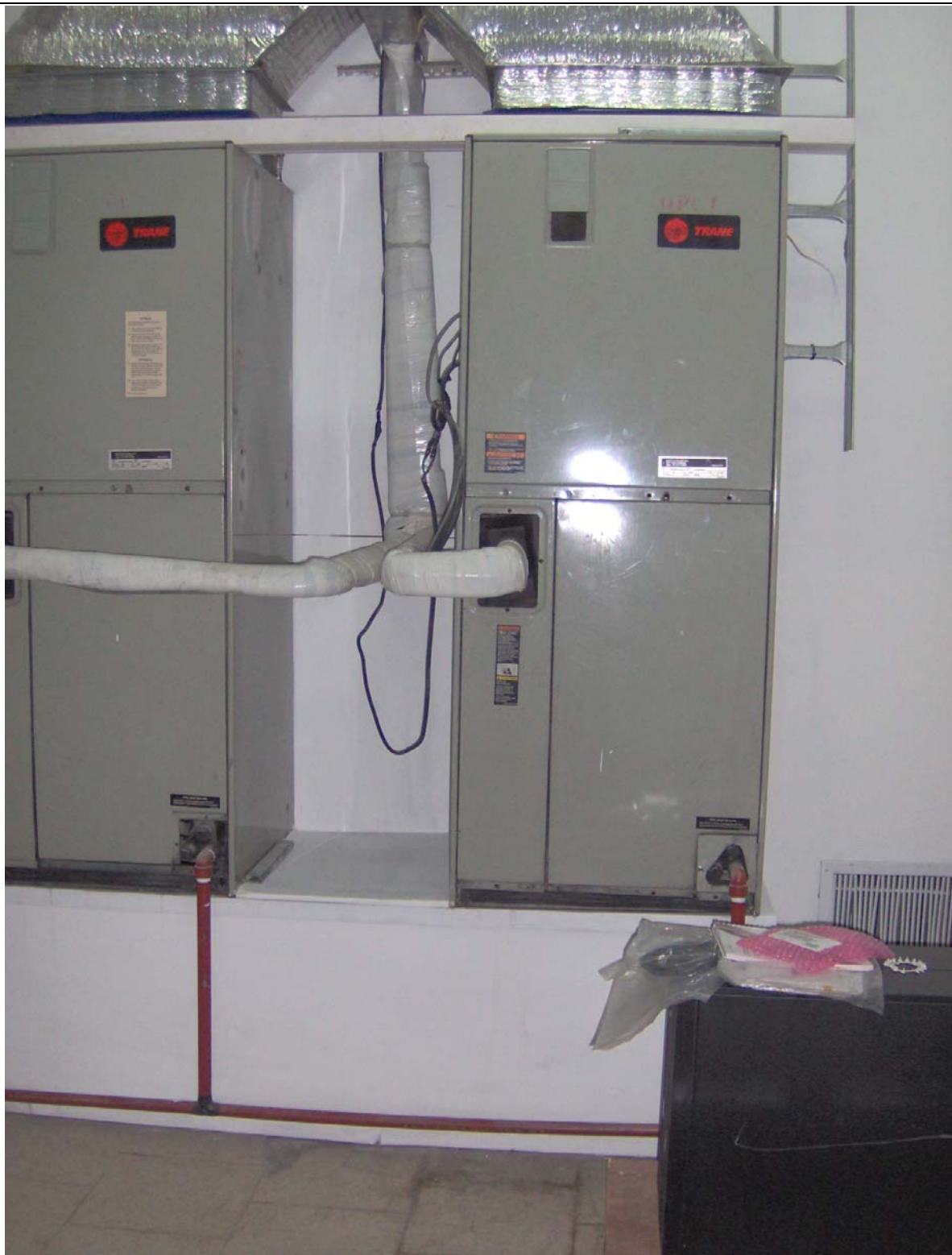
FOTO N° 7 – EQUIPOS DEL SISTEMA DE CALOR DEL AA, CON CABLES EXPUESTOS Y ENCINTADOS.
