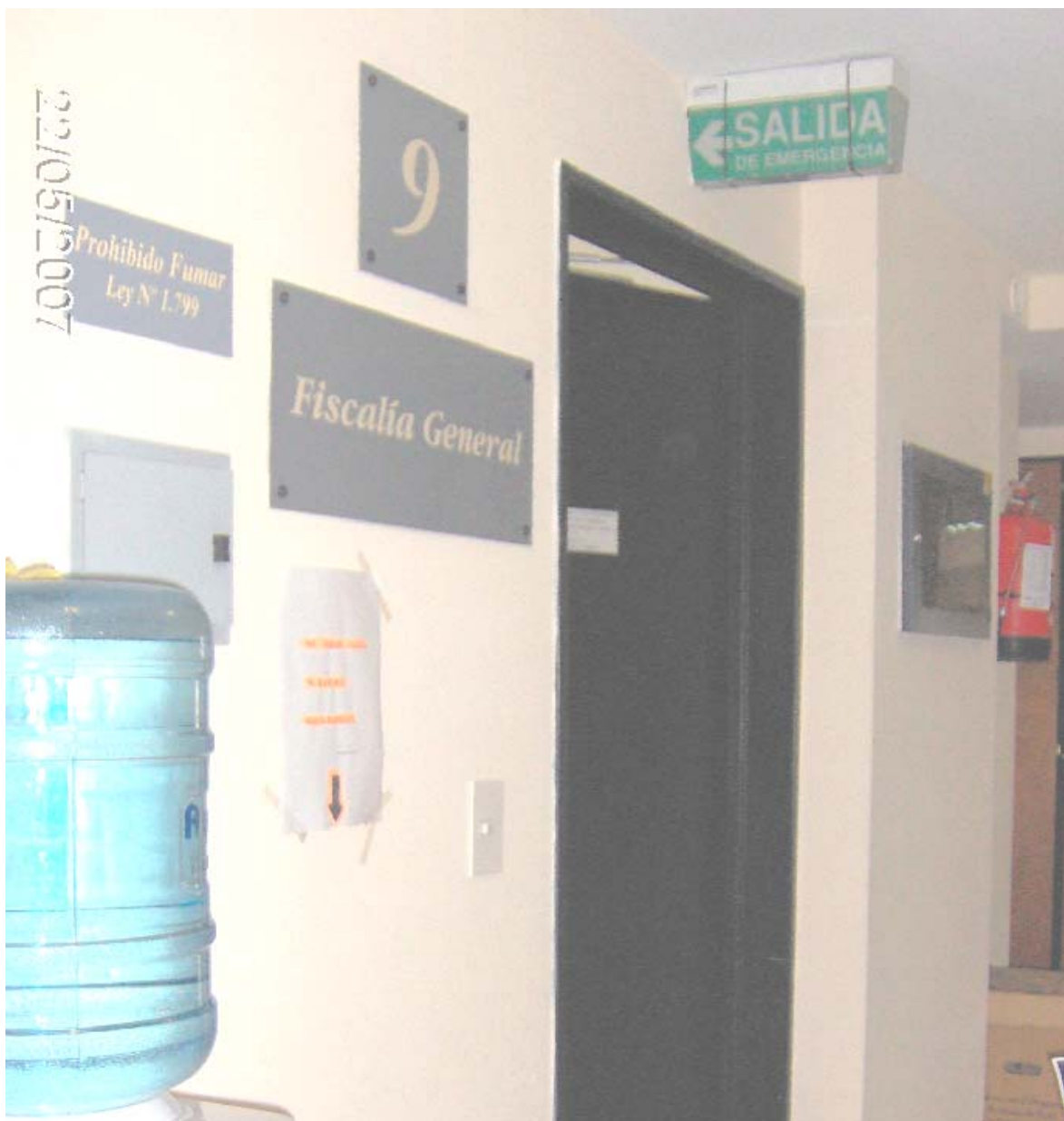
Foto N° 16 – Salida de emergencia con un cartel identificatorio sobre la misma, se puede observar que esta puerta de escape no tiene el manijón de seguridad, a la derecha un matafuego colocado sobre la pared.
