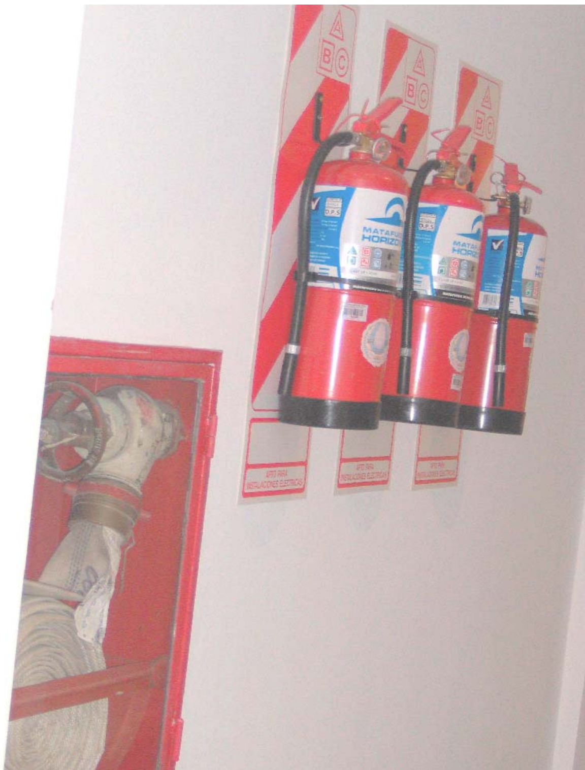
FOTO N° 27 – DEL SISTEMA CONTRA INCENDIO, CABINA CON MANGUERA Y LANZA, TRES MATAFUEGOS TIPO A, B Y C QUE ATACAN: FUEGOS EN GENERAL, LOS PRODUCIDOS POR COMBUSTIBLES Y POR INSTALACIONES ELÉCTRICAS.
