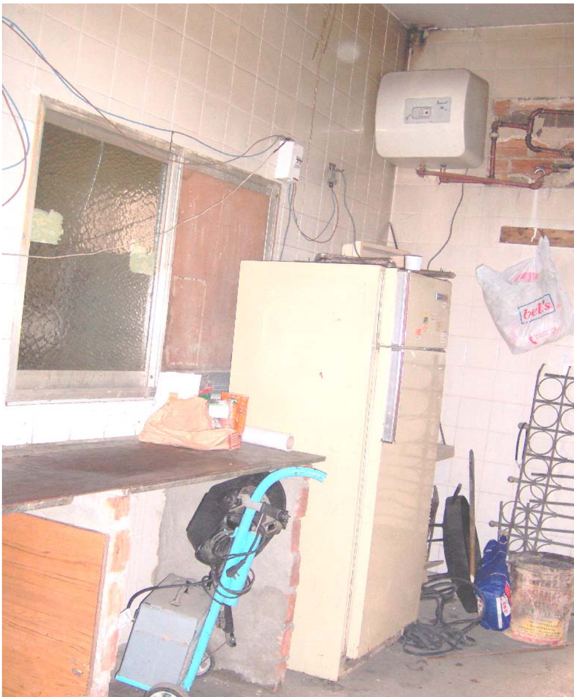
FOTO N° 42 – ESTA VISTA CORRESPONDE A LA PARTE DE MANTENIMIENTO UBICADA EN UNA ESQUINA DEL PATIO, EN LA MISMA SE PUEDEN VER CABLES EXPUESTOS COLGANDO DE LAS PAREDES, UN TOMA CORRIENTE EXTERIOR CON UNA FICHA ENCHUFADA EN UN LADO, UN CABLE QUE SOBRESALE DEL OTRO EXTREMO Y UN TERMO DE AGUA ALIMENTADO ELÉCTRICAMENTE POR UNO DE ESTOS CABLES.
