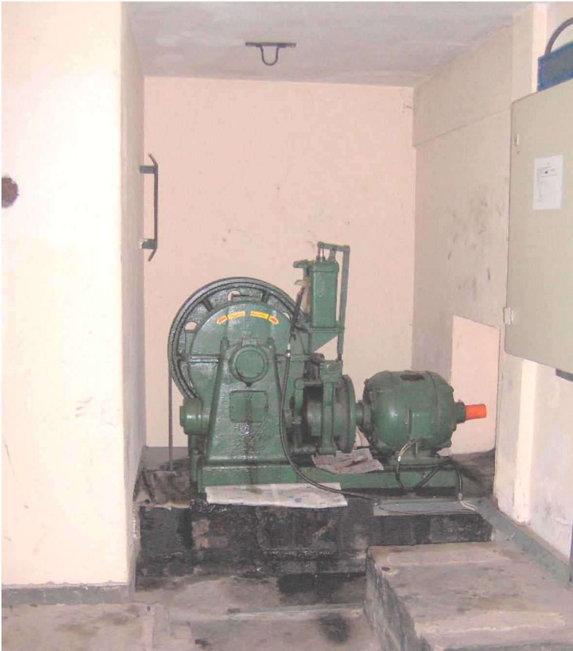
Foto N° 10 – Maquinaria y motor del montacargas con los cables de alimentación eléctrica expuestos .
