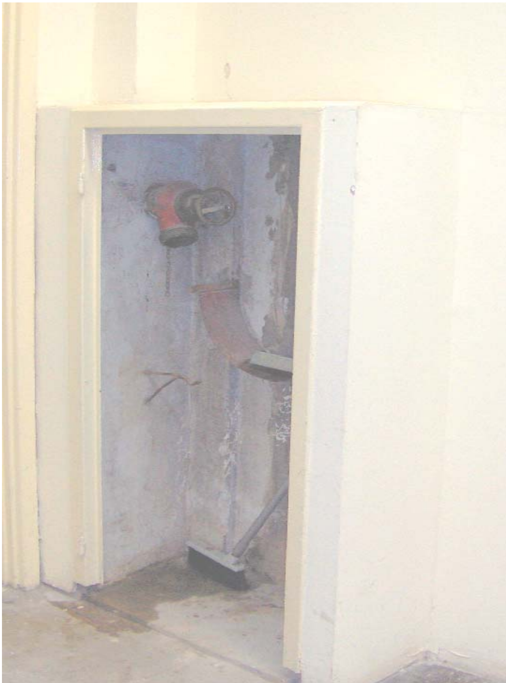
Foto N° 23 – Cabina del sistema contra incendio del cuarto piso sin la manguera y la lanza.
