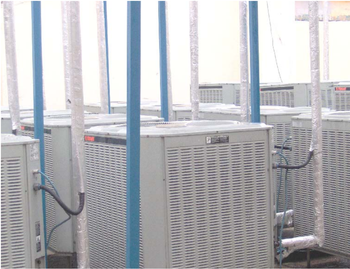
Foto N° 23 – Compresores del sistema de aire acondicionado ubicados en la terraza.
