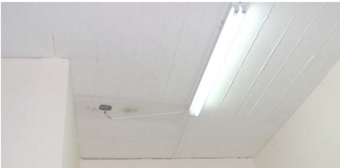
Foto N° 12 – En la presente vista se puede observar en el cielorraso del sótano un artefacto de iluminación y la alimentación eléctrica tomada desde una boca en el cielorraso presenta los cables expuestos y encintados.
