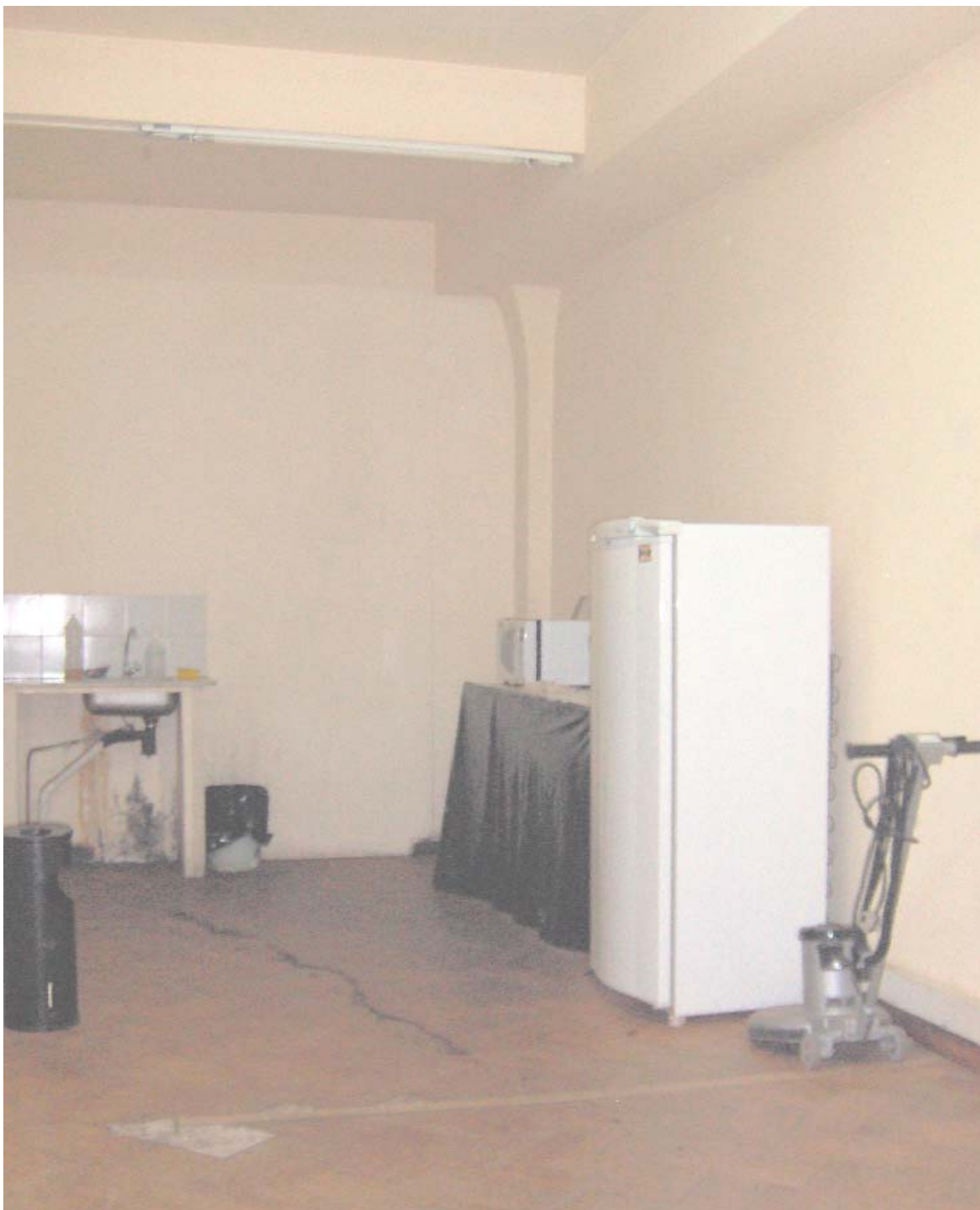
Foto N° 15 – En el piso de este office del cuarto piso se puede observar el solado roto.
