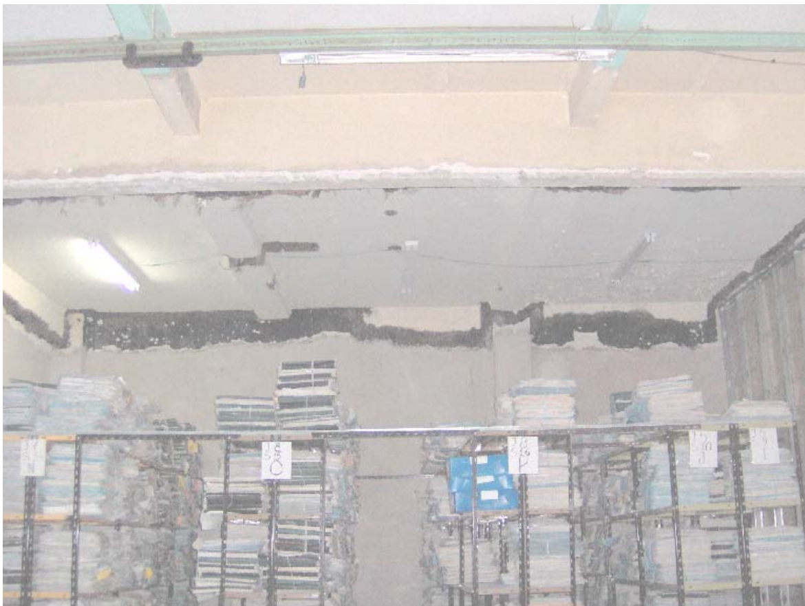
Foto N° 32 – Archivo del primer piso, en la presente vista se puede apreciar la cantidad de carpetas apiladas sobre estanterías metálicas de estructuras muy frágiles y sobre el cielorraso se puede ver la iluminación de tubos con los conductores de alimentación eléctrica colgando y expuestos .
