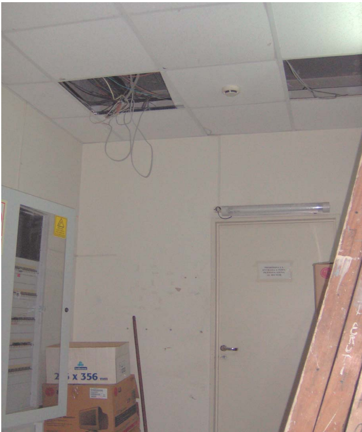
FOTO N° 4 – EN LA PRESENTE VISTA SE PUEDE OBSERVAR UN TABLERO DE ELECTRICIDAD SECCIONAL, SOBRE LA PUERTA UN TUBO DE LA LUZ DE EMERGENCIA Y EN EL CIELORRASO ARMADO CON PAÑOS DE 50 x 50 CM DONDE FALTAN DOS, DE LOS MISMOS SOBRESALEN CONDUCTORES ELÉCTRICOS Y DE SISTEMAS EXPUESTOS Y ENTRE ESTOS DOS PANELES HAY UNO CON UN CENSOR DETECTOR DE HUMOS.
