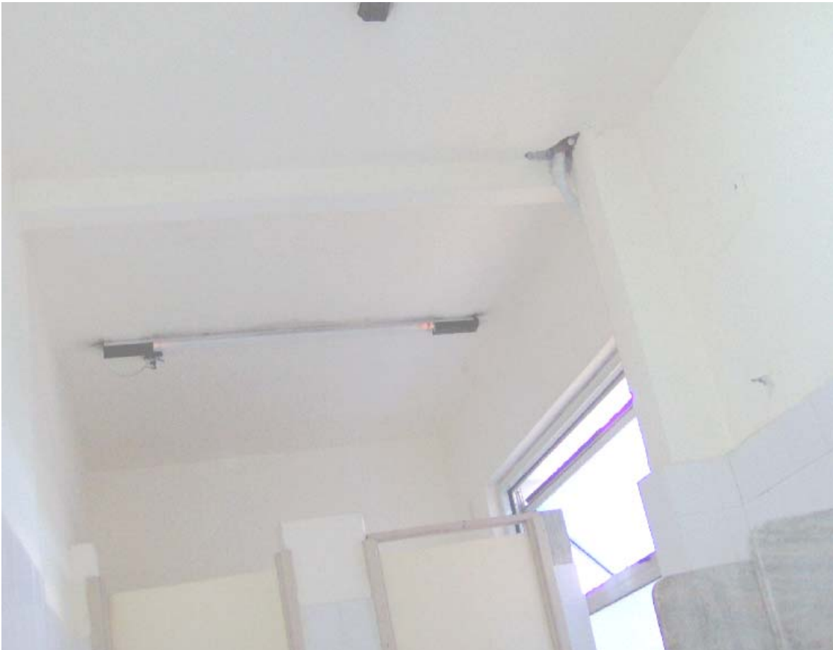
FOTO N° 18 – ARTEFACTO DE ILUMINACIÓN DE EMERGENCIA DENTRO DE UN SANITARIO, UNA CONEXIÓN DE UN EQUIPO DE AIRE ACONDICIONADO SPLIT QUE ASOMA EN UNA DE LAS ESQUINAS Y EN EL MEDIO DEL CIELORRASO UN CENSOR DETECTOR DE HUMO.
