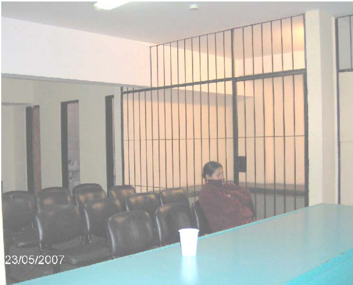
Foto N° 18 – En el entrepiso hay dependencias policiales. En la presente toma se puede observar una sala de espera y una celda, en el cielorraso se observa un detector de humo pero este sistema no funciona.
