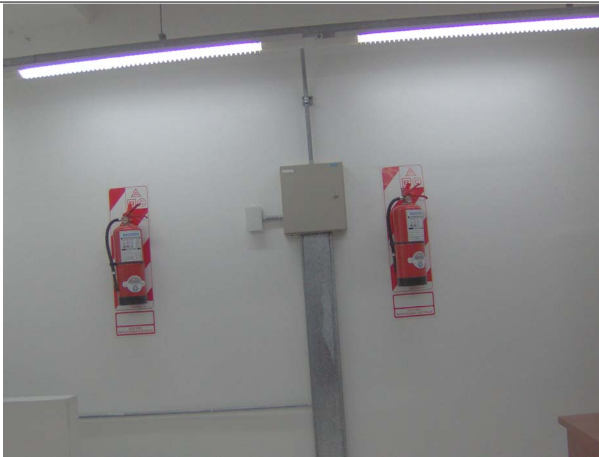
FOTO N° 10 – UNA CAJA DE ELECTRICIDAD SECCIONAL Y DOS MATAFUEGOS DEL TIPO A, B Y C APOYADOS SOBRE LAS CHAPAS IDENTIFICATORIAS.
