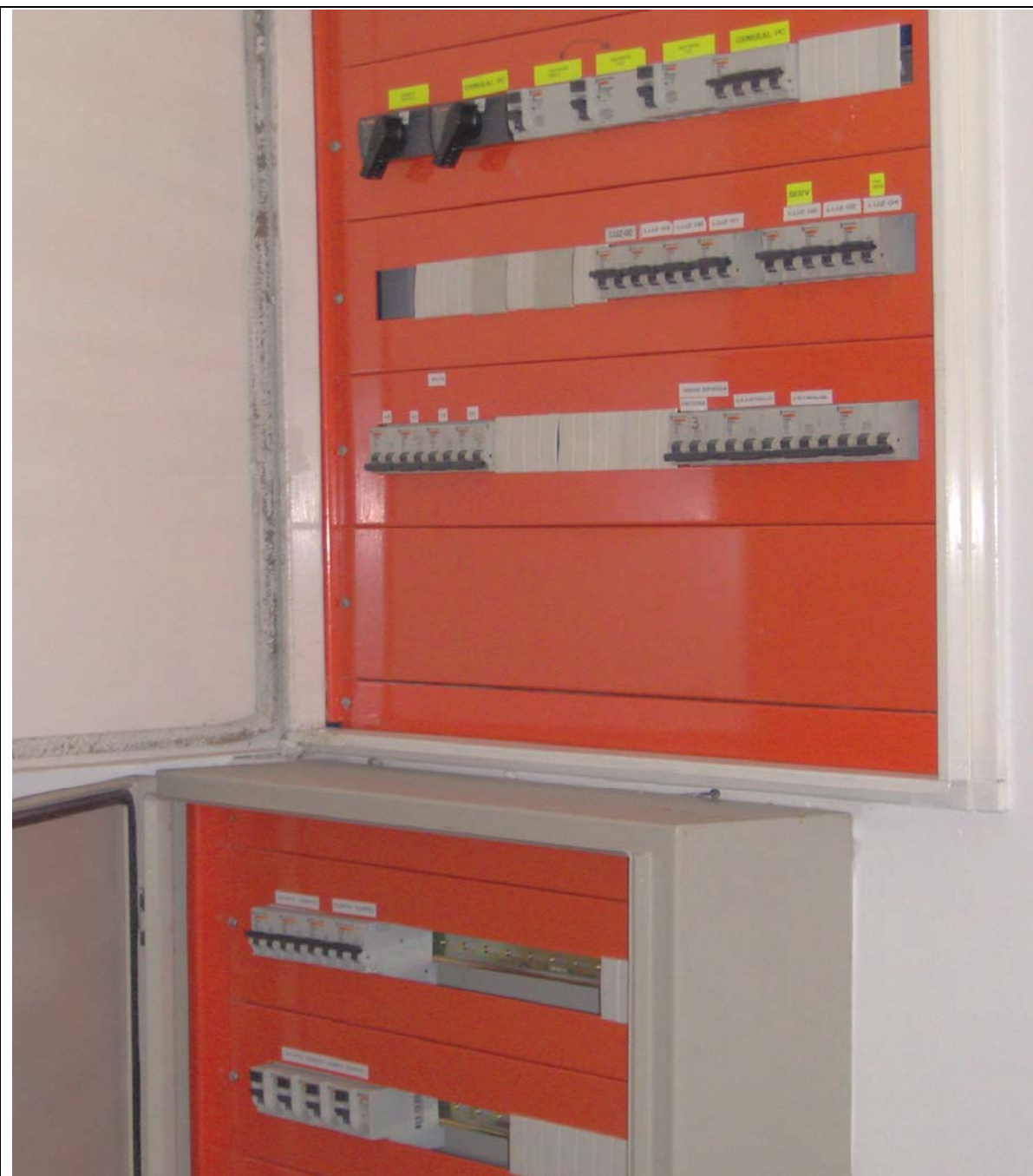
FOTO N° 18 – TABLERO DE ELECTRICIDAD SECCIONAL DE PISO.
