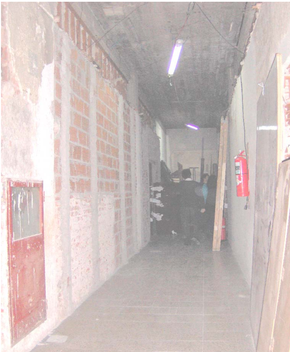
Foto N° 31 – Pasillo del tercer piso en obra y sin revestimientos en los muros, con un matafuego sobre una pared y por detrás de este elemento un cable con un portalámpara colgando. La iluminación sobre el cielorraso tiene los cables de alimentación expuestos y encintados , en la otra parte del piso trabajan empleados.
