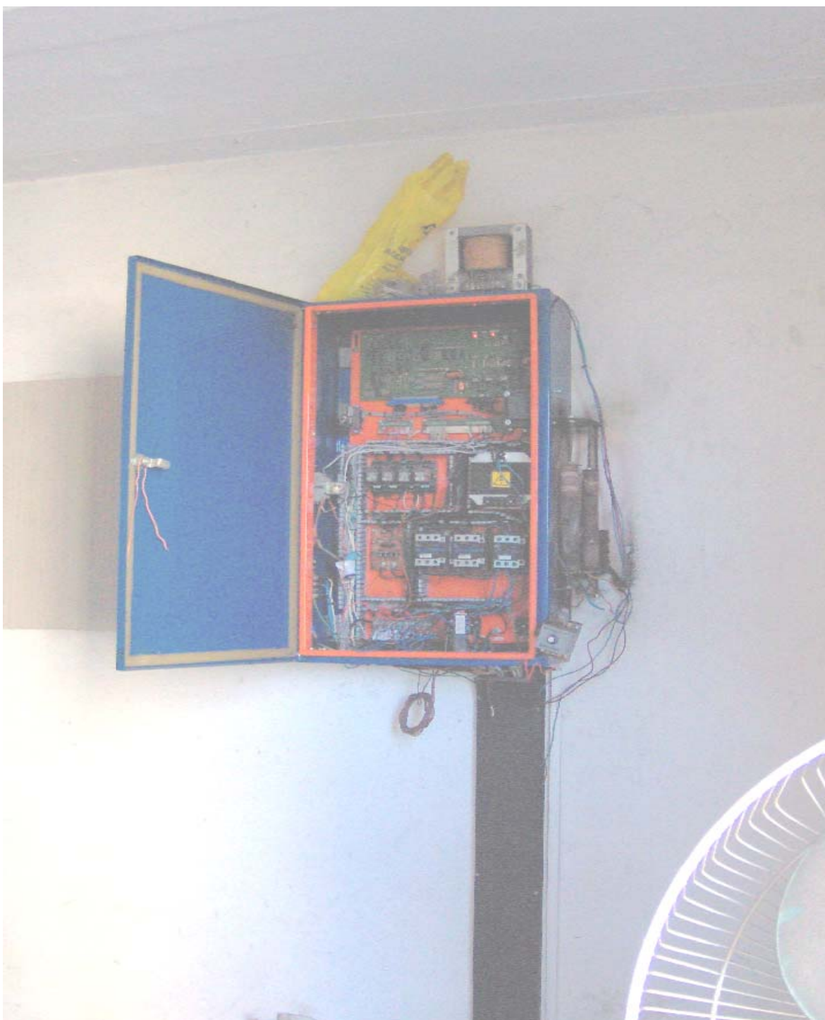
Foto N° 14 – Central de teléfonos con conexiones exteriores y gran desprolijidad.
