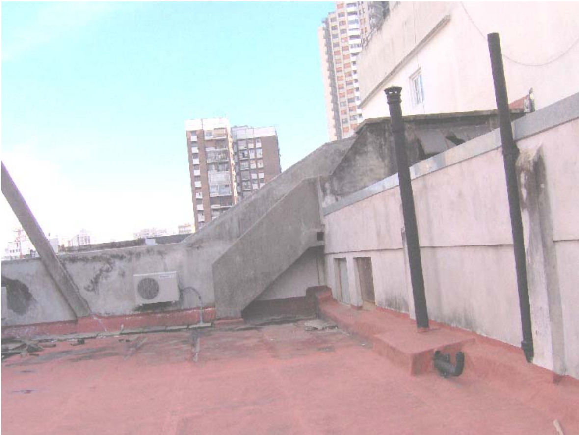
Foto N° 11 – Terraza del edificio donde están ubicados los compresores de los equipos de aire acondicionado split.
