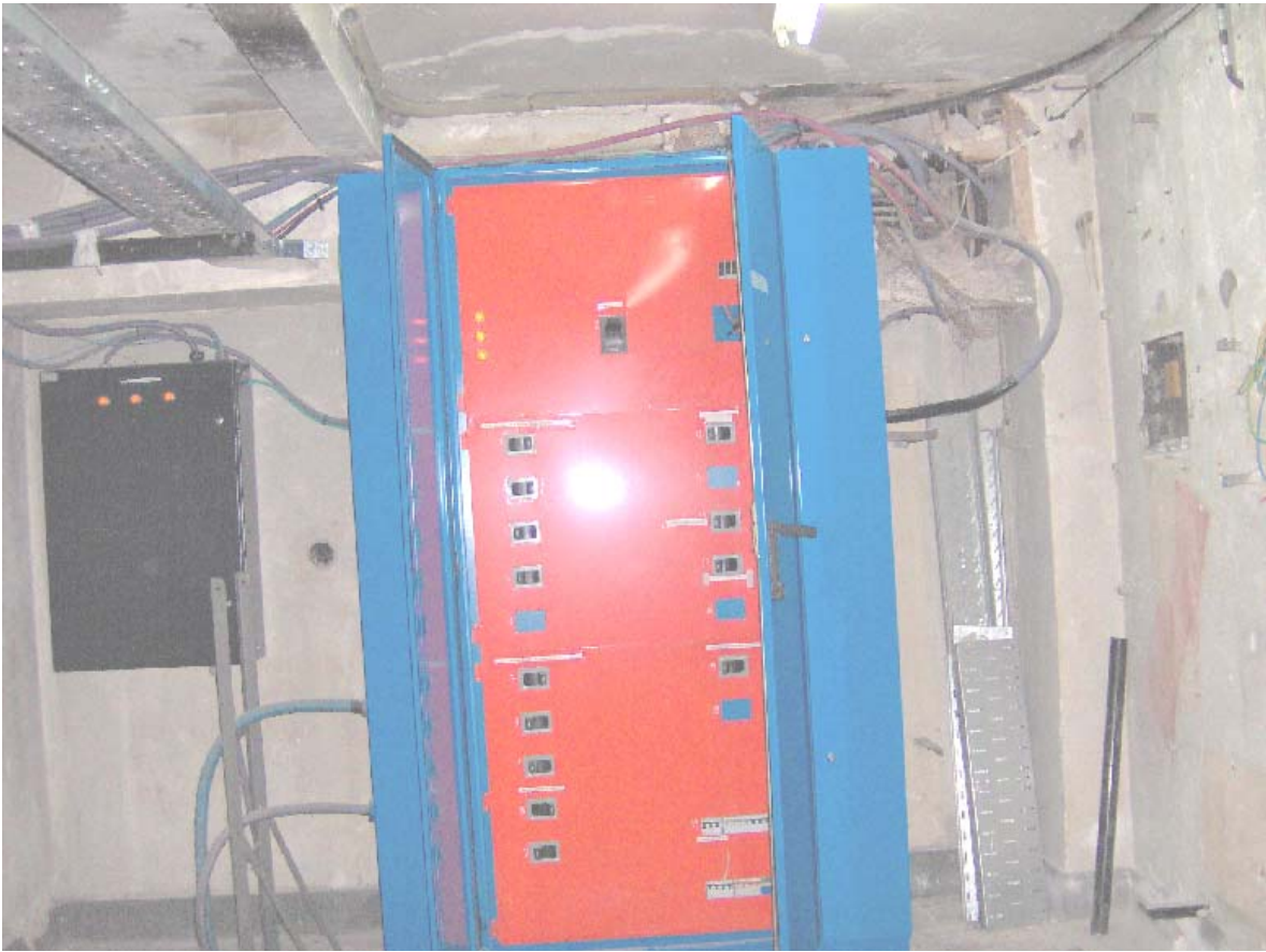
FOTO N° 41 – TABLERO PRINCIPAL EN EL SUBSUELO APOYADO SOBRE EL PISO SIN AMURAR (HAY OTRO EN EL SECTOR DEL CGP 2), ES DE NOTAR QUE ESTE SECTOR DEL SUBSUELO ESTA EN OBRA, PERO FUNCIONANDO COMO PARTE DEL ORGANISMO, EN ESTA VISTA SE PUEDE APRECIAR UN GRAN DESORDEN EN EL CABLEADO QUE SALE DEL TABLERO CON CABLES EXPUESTOS, ESTE PISO TAMBIÉN SE USA COMO DEPÓSITO DE ENSERES Y MUEBLES POR LO QUE NO SE CUMPLE CON LAS NORMAS SOBRE SEGURIDAD.
