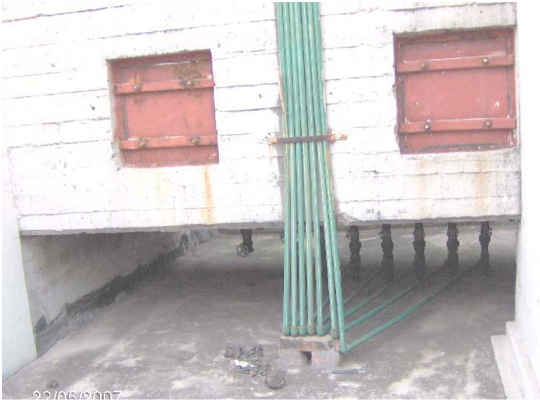
FOTO N° 3 – TANQUE DE AGUA DE RESERVA EN LA TERRAZA SOBRE EL 9° PISO, EN LA PARTE INFERIOR DEL TANQUE SE DISTINGUE LA COLECTORA CON LOS CAÑOS DE BAJADAS PARA LA ALIMENTACIÓN A LOS DIFERENTES PISOS. SE OBSERVA QUE NO HAY CONEXIÓN PARA EL SISTEMA CONTRA INCENDIO.
