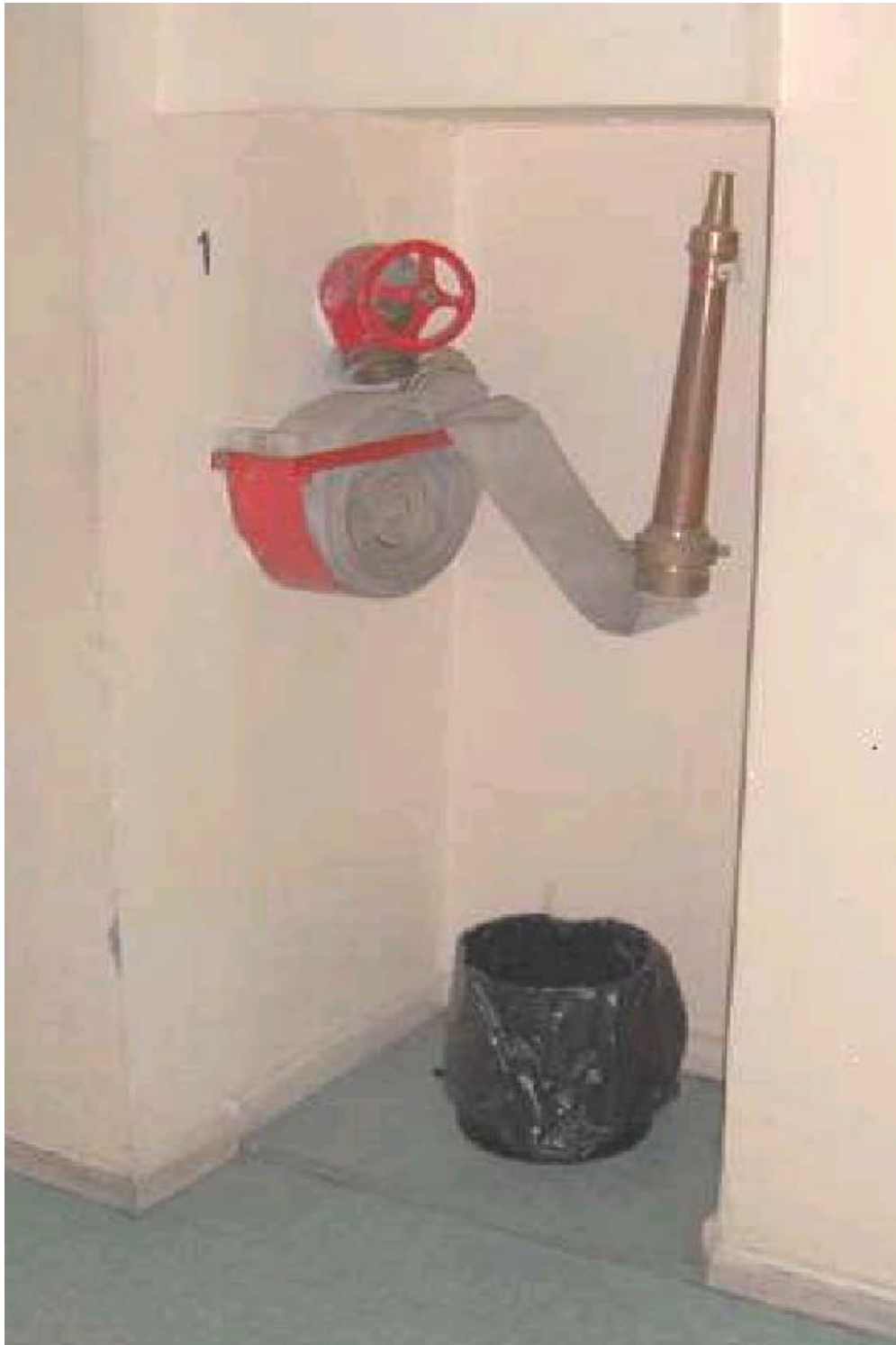
Foto N° 2 – Nicho en primer piso con la manguera y lanza del sistema contra incendio sin conectar.
