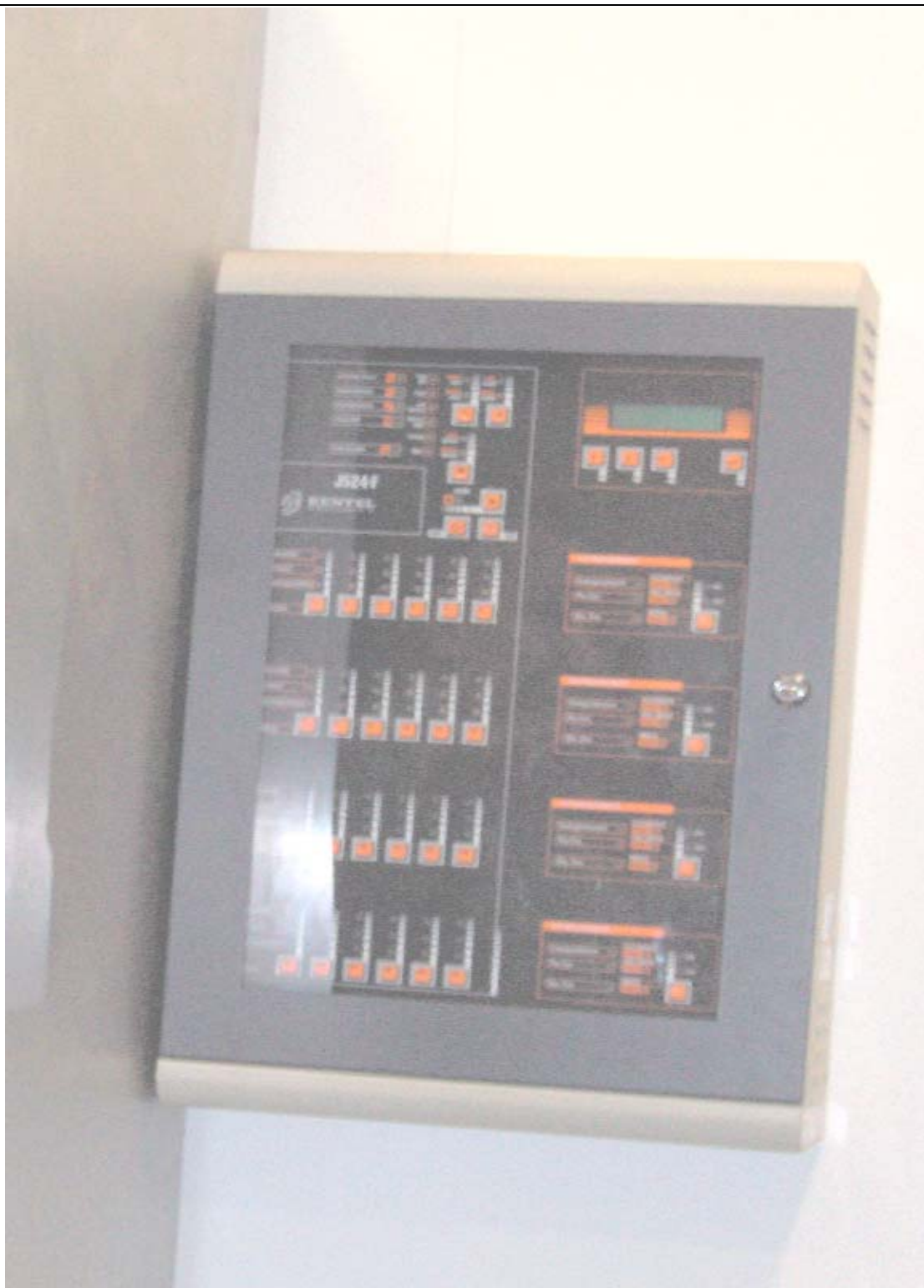
FOTO N° 16 – TABLERO DE LA EMPRESA NESTEL, SISTEMA DE RADIO LLAMADAS.
