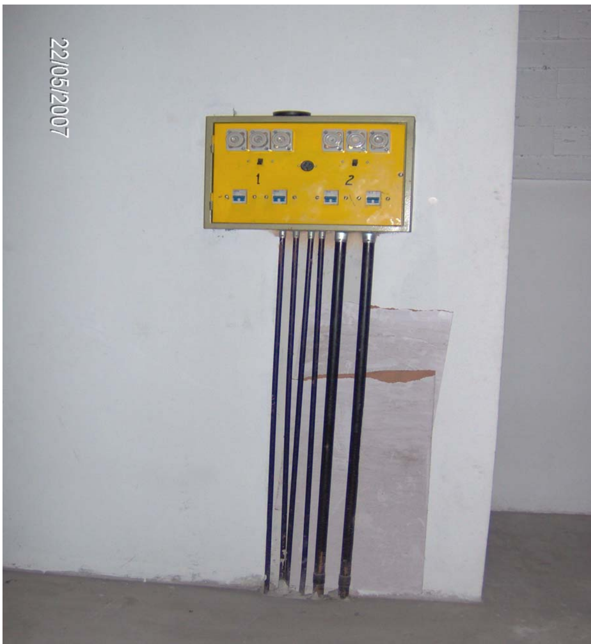
Foto N° 9 – Sala de motores de los ascensores, en la presente vista se puede observar un tablero de electricidad con llaves térmicas y fusibles cerámicos de corte de electricidad.
