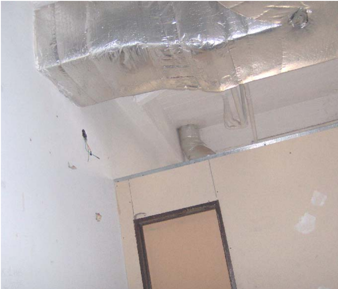
Foto N° 28 – En la presente vista se puede observar una pared de durlock sin revestimiento y sobre la pared una boca de iluminación con los conductores eléctricos expuestos y encintados.
