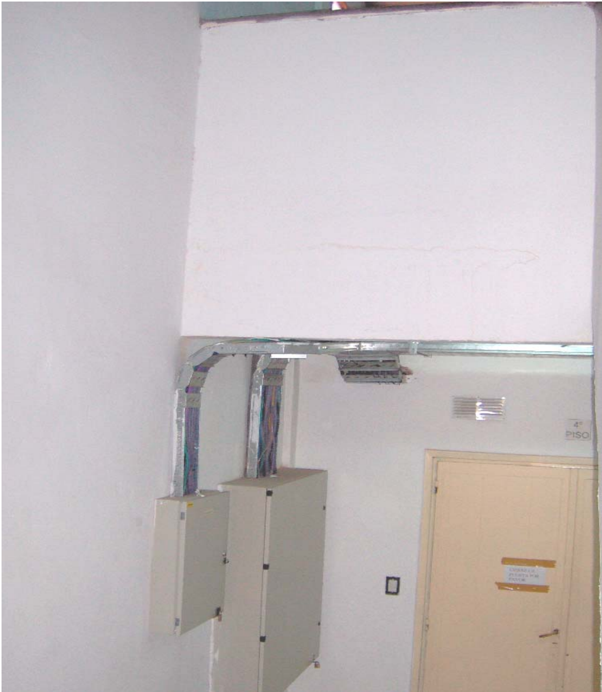
Foto N° 19 – Tablero seccional de electricidad del cuarto piso.
