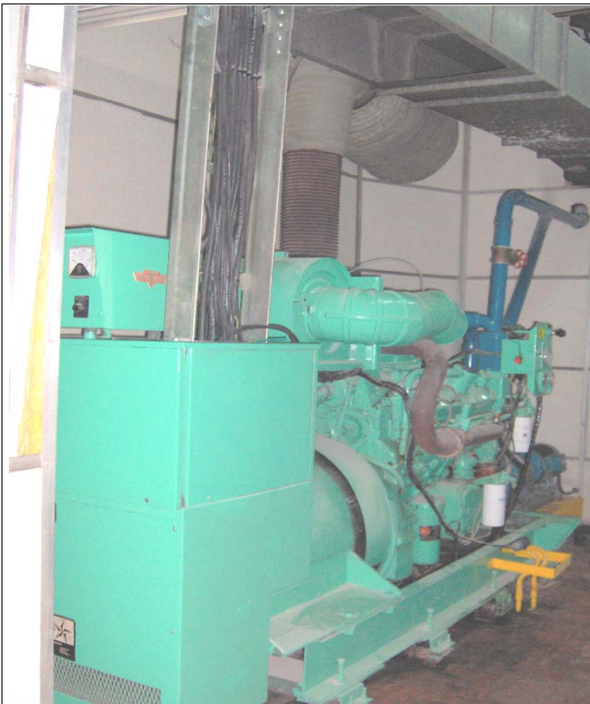
FOTO N° 13 – GENERADOR DE CORRIENTE ALTERNA CON MOTOR DIESEL, EQUIPO DE AUXILIO POR POSIBLES CORTES DE CORRIENTE ELÉCTRICA.
