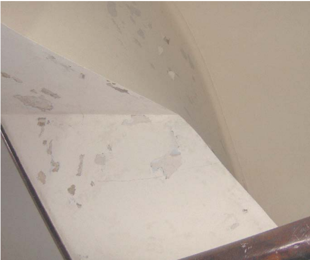
Foto N° 6 – Deterioro de una pared en el descanso de la escalera del cuarto piso.
