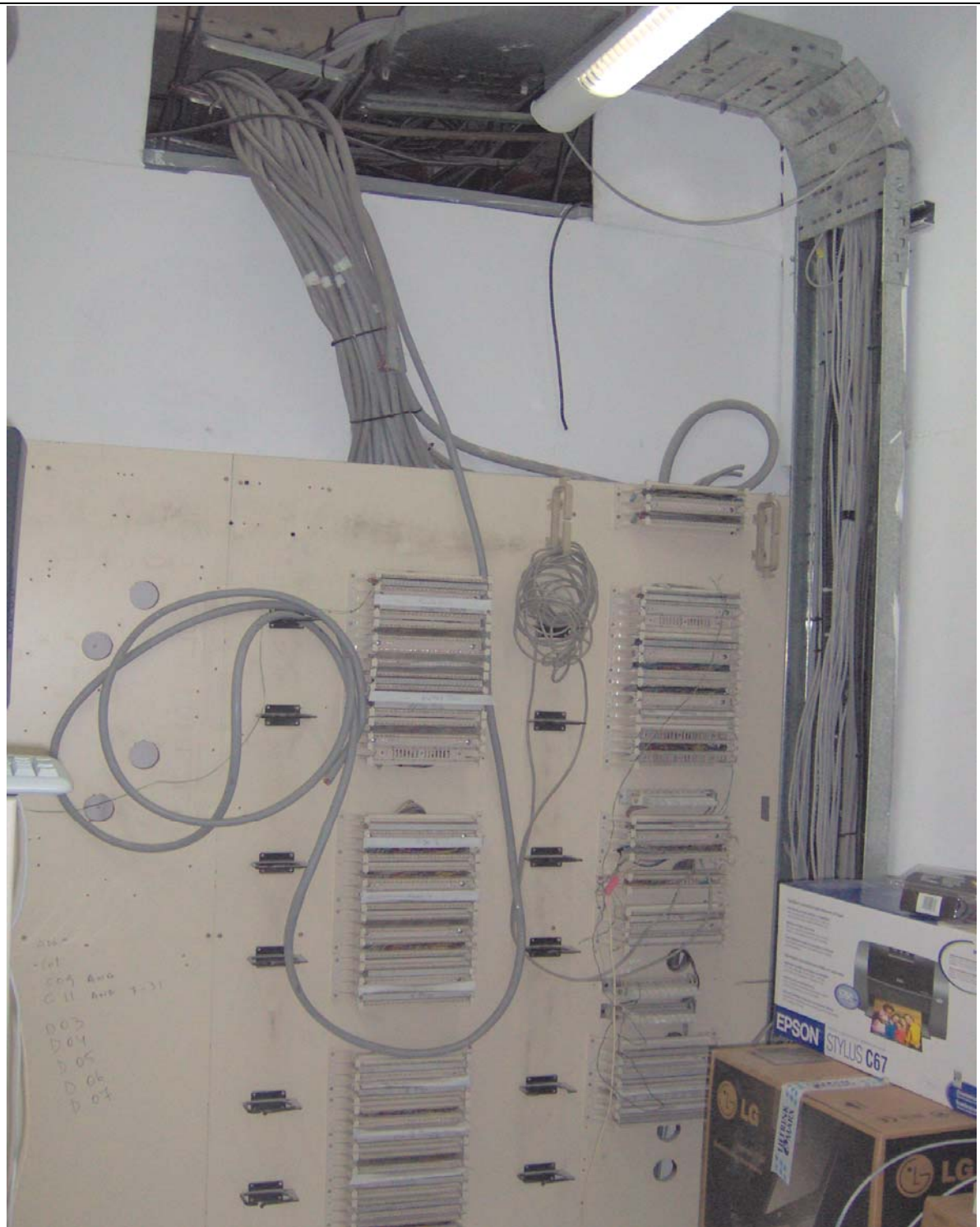
FOTO N° 8 – SALA DE UPS CON TABLEROS (EN ESTE MOMENTO SE ENCUENTRAN EN LA ETAPA DE ARMADO DEL SISTEMA ).
