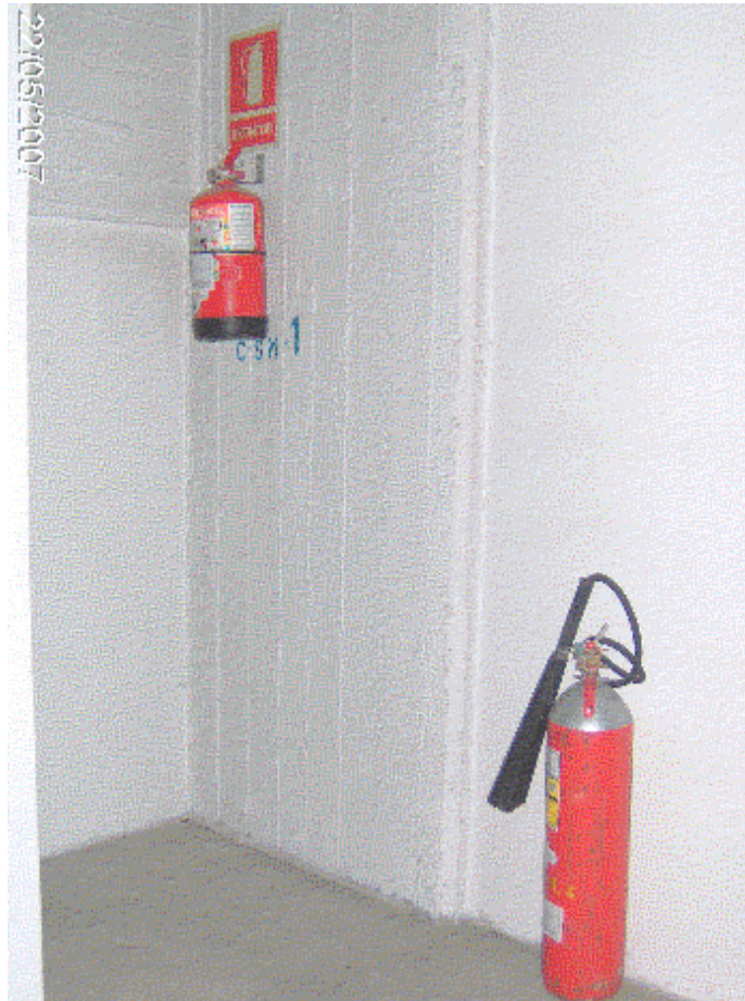
FOTO N° 11 – SALA DE MOTORES DE LOS ASCENSORES, EN LA PRESENTE VISTA SE PUEDEN OBSERVAR LOS DOS MATAFUEGOS REGLAMENTARIOS. ES DE NOTAR QUE TODOS LOS MATAFUEGOS ESTÁN CON LA CARGA ACTUALIZADA, ESTE TRABAJO LO EFECTÚA POR CONTRATO UNA EMPRESA ESPECIALIZADA.
