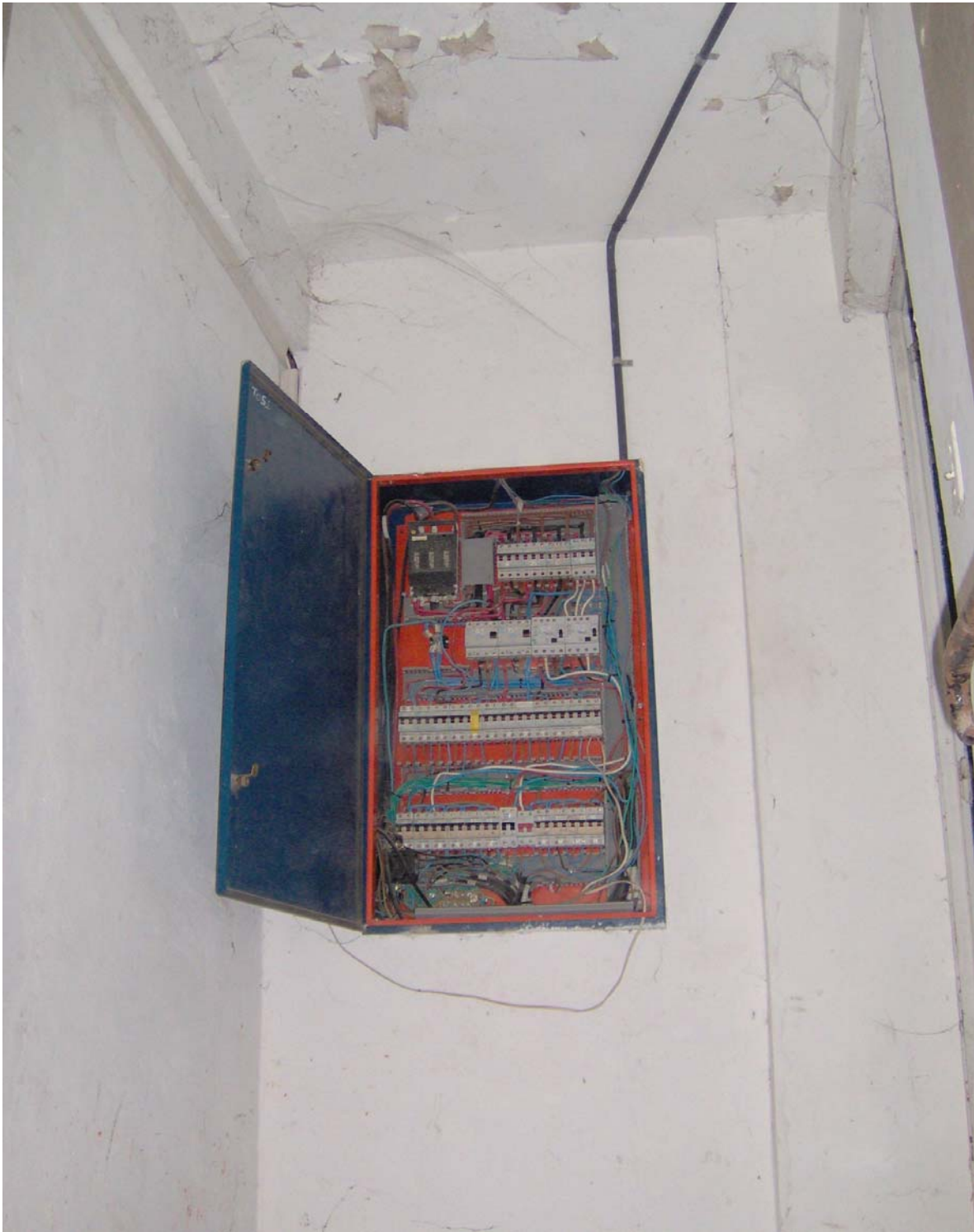
Foto N° 38 Tablero de telefonía en el sector del primer piso.
