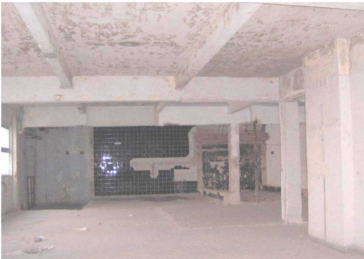
Foto N° 7 – Estado general del interior del quinto piso donde se puede observar el deterioro y estado de demolición generalizado, sin paredes interiores ni revestimientos en las existentes.
