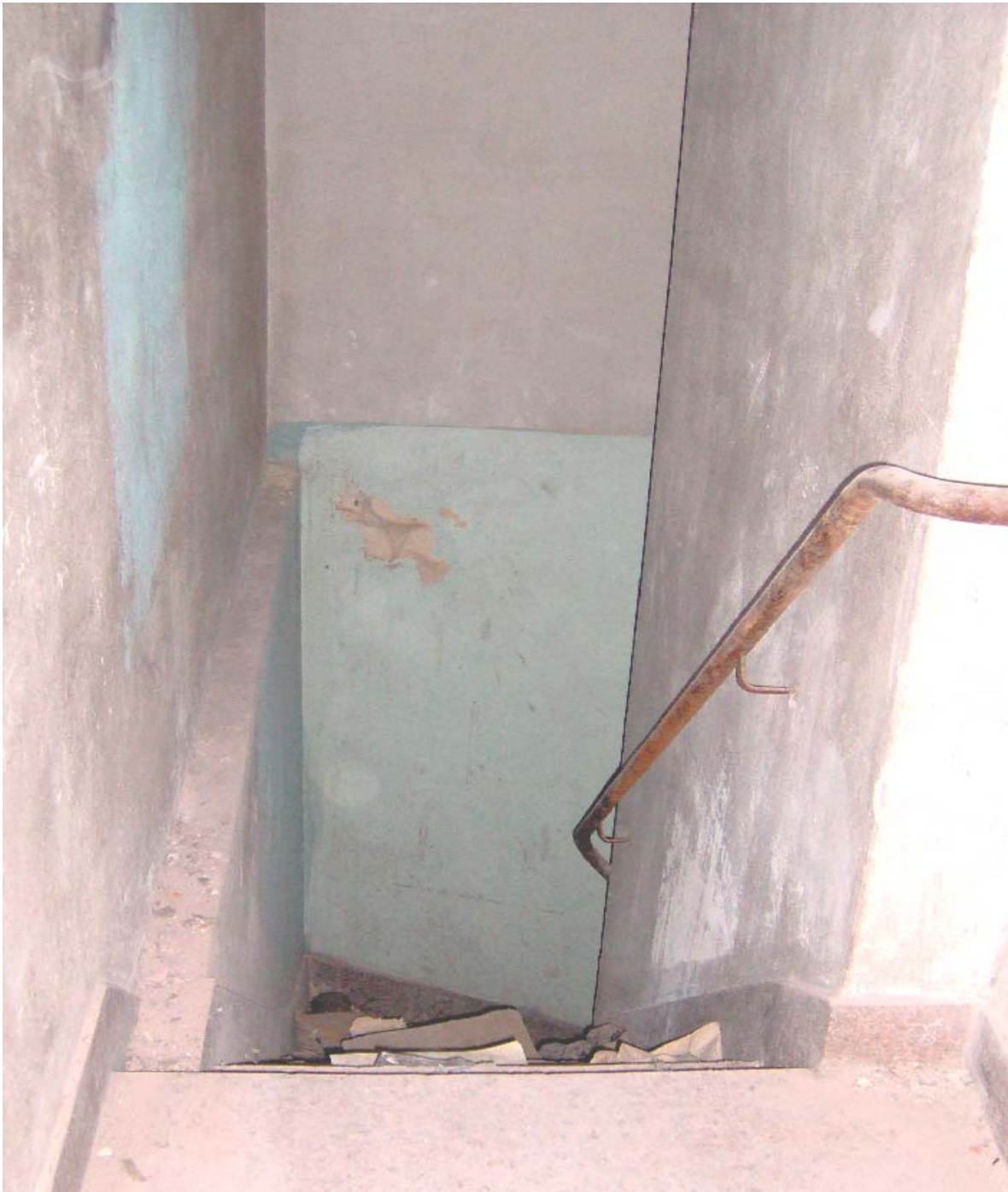
Foto N° 9 – Escalera que baja del 5° al 4° piso, en estado de abandono, con basura en sus escalones y descanso.
