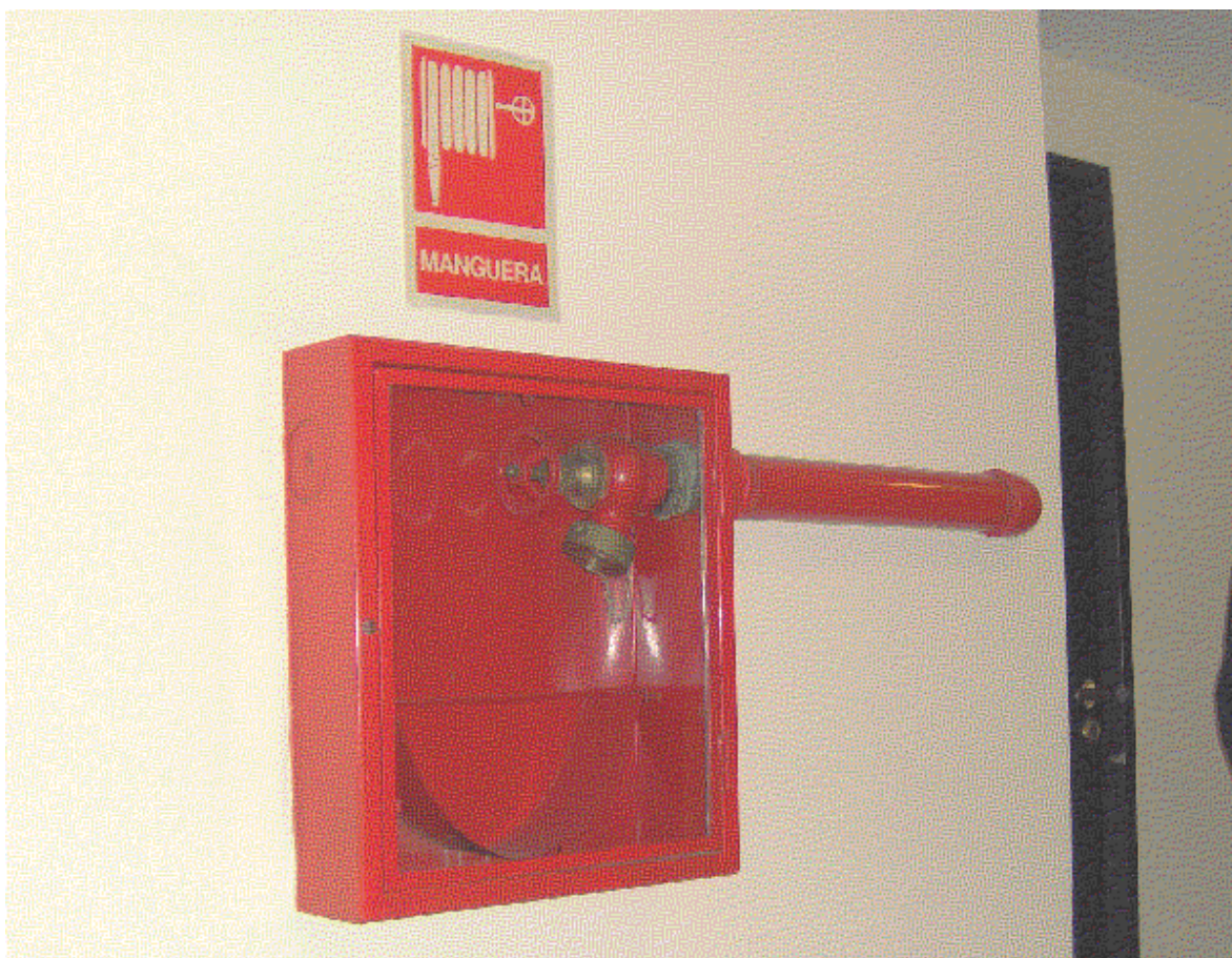
Foto N° 12 – Cabina para la manguera del sistema contra incendio en el 7° piso, es de notar que esta vacía sin la manguera y la lanza.
