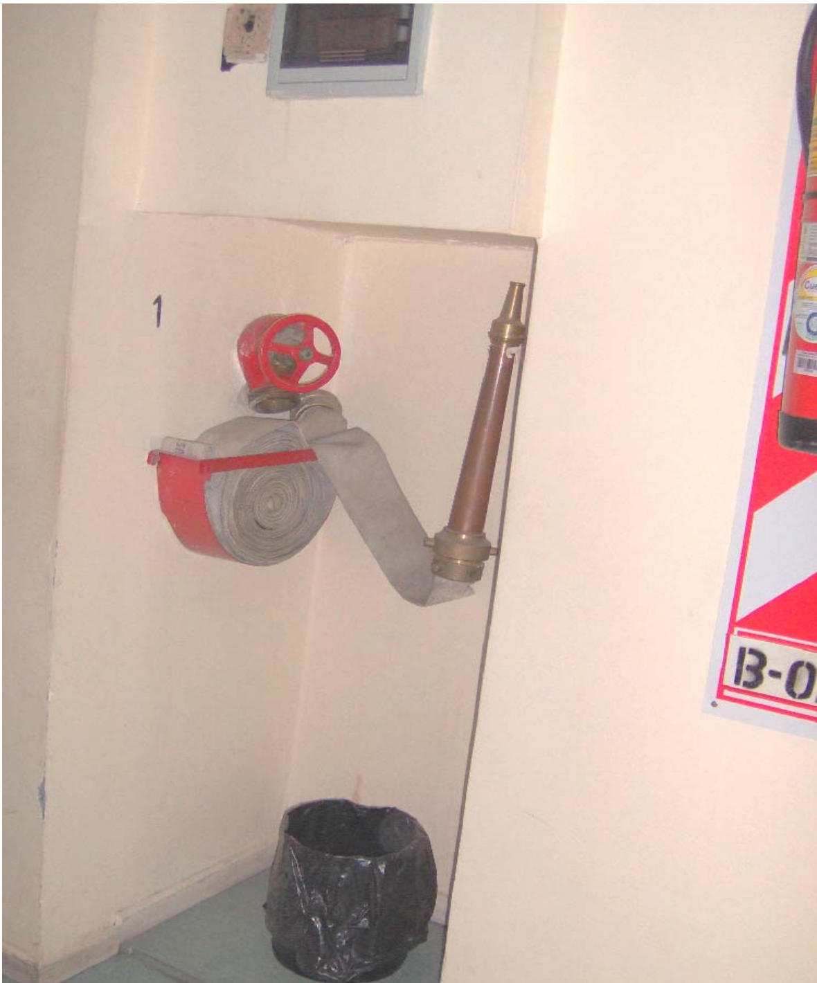
Foto N° 25 – Cabina del sistema contra incendio con la manguera y la lanza conectada, encima una central del sistema contra incendio y al costado un matafuegos colocado sobre una chapa reglamentaria.
