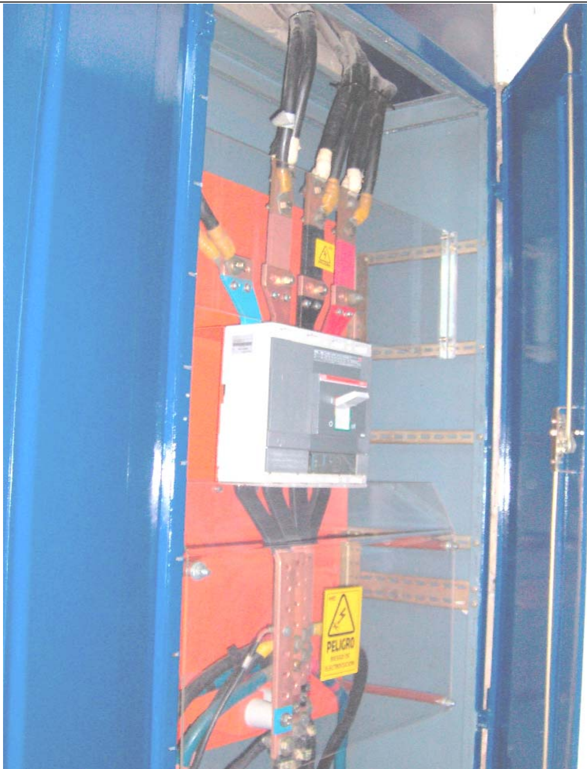
FOTO N° 12 – LLAVE INVERSORA DEL SISTEMA DE AUXILIO (GRUPO ELECTRÓGENO-CORRIENTE DE LA COMPAÑÍA EDENOR).
