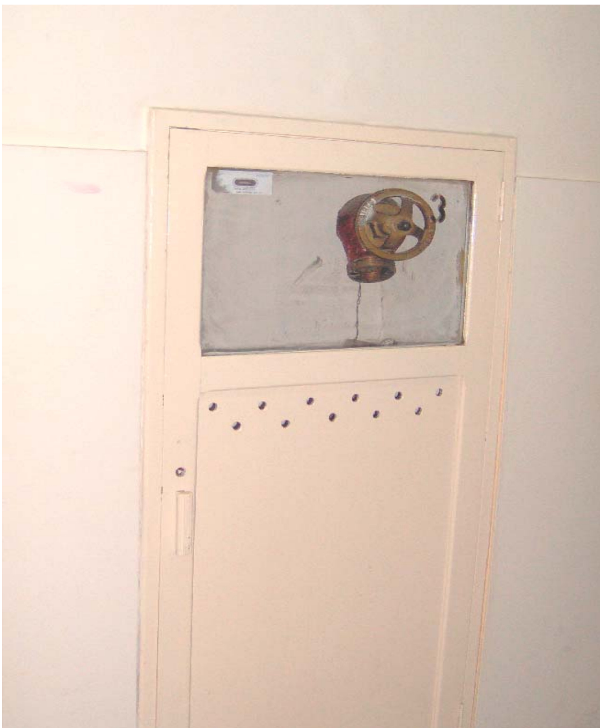
Foto N° 16 – Cabina del sistema contra incendio del 3° piso sin manguera y lanza.
