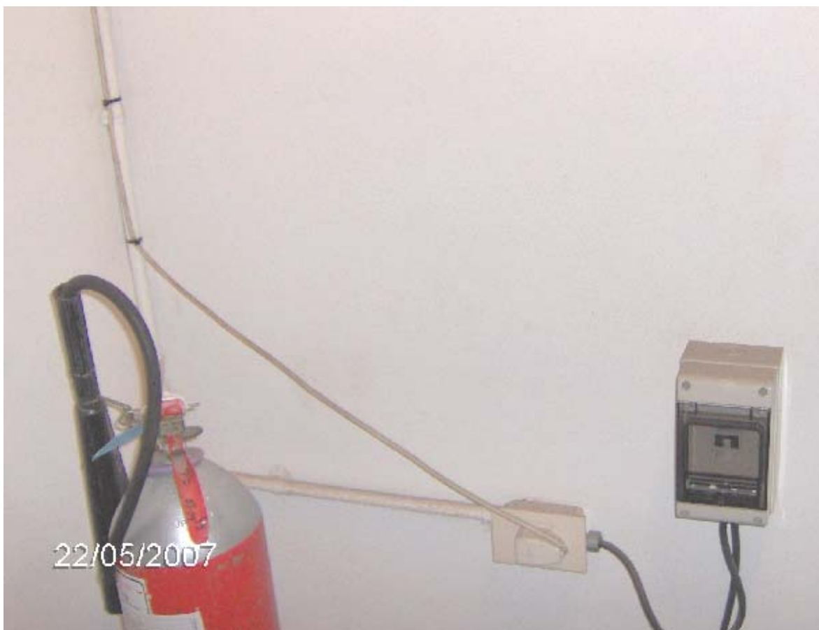
Foto N° 15 – Sala del termo para agua caliente, en la presente vista se pueden observar un matafuego apoyado en el piso y cables de electricidad expuestos, conectados en forma peligrosa (tirante).
