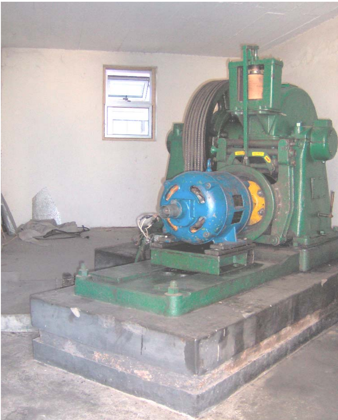
Foto N° 13 – Motor de un montacargas donde se pueden observar que los cables de alimentación eléctrica están expuestos y encintados.
