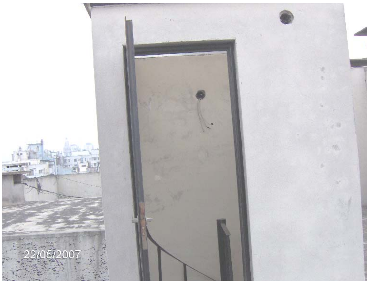
Foto N° 4 – Salida a la terraza donde se puede apreciar la escalera tipo caracol de herrería que sube desde el nivel del 9° piso, esta escalera de 0,55 m de ancho es prefabricada y no cumple con las medidas mínimas (según el CE 4.6.3.5 a) (2) El ancho libre no será menor que 0,70 m.). Dentro del sobre recorrido de la escalera en la pared del fondo se puede observar una boca de iluminación con los cables de electricidad expuestos y encintados.
