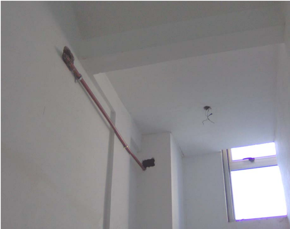
Foto N° 24 – Sanitario del primer piso con un centro de iluminación sin artefacto y con los cables de electricidad expuestos y encintados.
