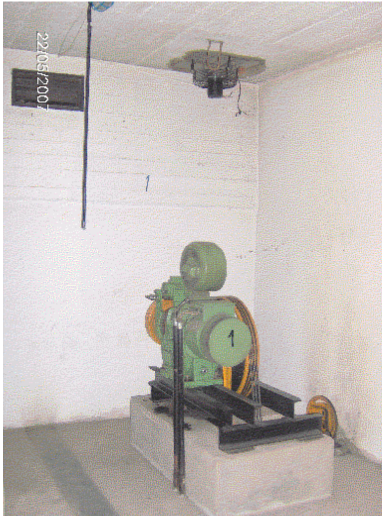
Foto N° 8 – Sala de motores de los ascensores, en la parte superior sobre el cielorraso se puede observar un extractor con los cables de la conexión eléctrica desconectados, expuestos y encintados.
