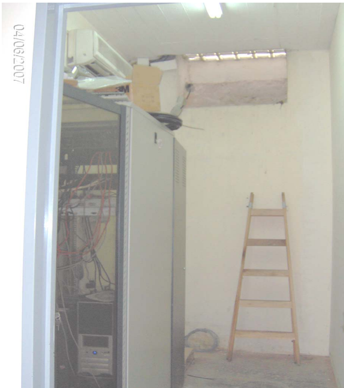
Foto N° 11 – En la presente vista del recinto donde están los servidores de computación se puede observar cerca del cielorraso un equipo de aire acondicionado split para mantener baja la temperatura de este lugar y sobre la pared del frente un cable expuesto alimentado desde un tomacorriente precario.
