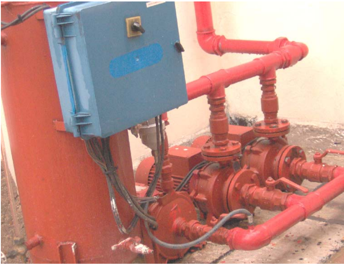
Foto N° 22 – Bombas impulsoras de agua, aspiran desde el tanque de bombeo en el sótano y envían al tanque de reserva en la azotea.
