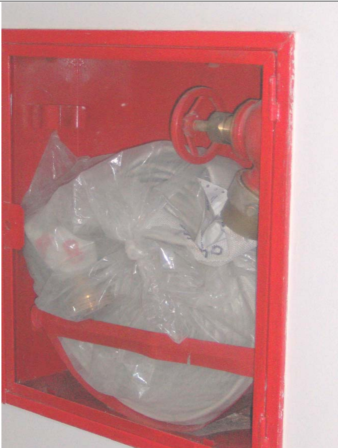
FOTO N° 19 – CABINA DEL SISTEMA CONTRA INCENDIO CON LA MANGUERA Y LANZA (DESCONECTADO TODAVÍA POR ESTAR EN OBRA).
