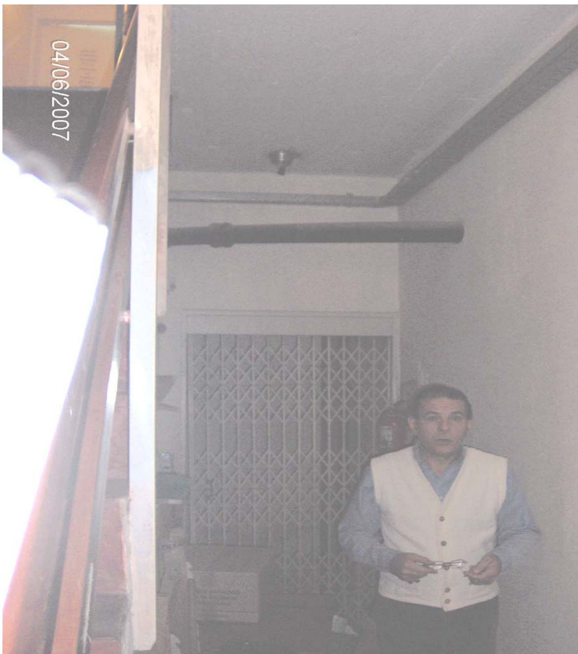
FOTO N° 13 – EN LA PRESENTE VISTA SE PUEDE OBSERVAR AL FONDO, LA PUERTA TIJERA DEL ASCENSOR (QUE NO FUNCIONA) Y SOBRE ESTA, EN EL CIELORRASO, UN CENTRO DE ILUMINACIÓN Y COLGANDO DE LOS CABLES DE ALIMENTACIÓN (EXPUESTOS) UN PORTALÁMPARA. ES DE NOTAR QUE AL NO FUNCIONAR EL ASCENSOR LOS DISCAPACITADOS NO PUEDEN ACCEDER A LOS PISOS SUPERIORES.
