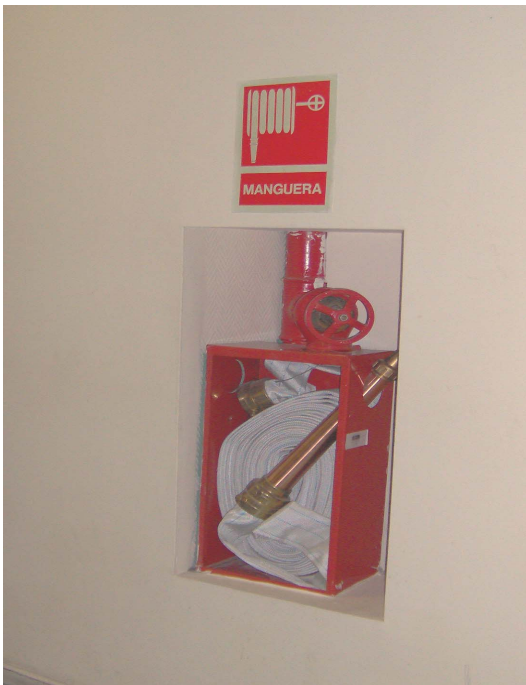
Foto N° 26 – Cabina del sistema contra incendio en el primer piso con la manguera y la lanza conectada por encima una chapa explicativa reglamentaria.
