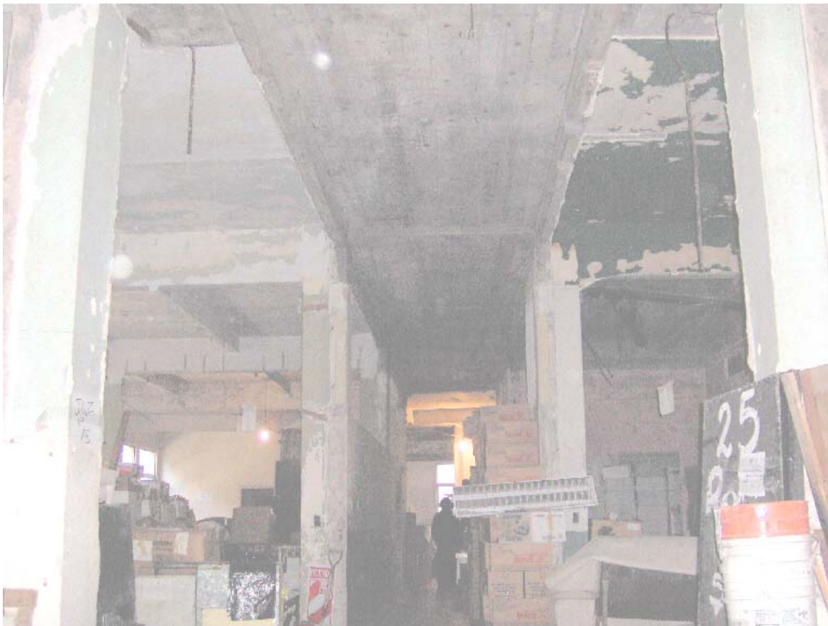
FOTO N° 35 – SECTOR DEL PRIMER PISO SOBRE LA AVENIDA CORONEL DÍAZ SIN REFACCIONAR, CON LA ILUMINACIÓN COLGANDO DE CABLES EXPUESTOS Y SOBRE EL PISO APILADOS CANTIDAD DE ELEMENTOS REQUISADOS EN LOS OPERATIVOS DE LA DGFYC.
